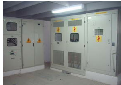
Imagen. Transformador en seco.
