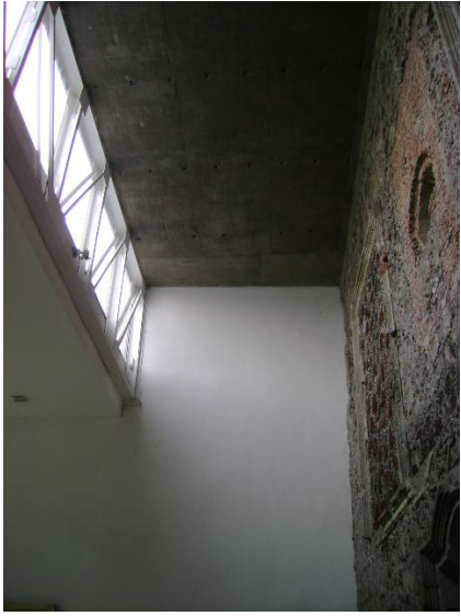
Detalle de iluminación indirecta.
