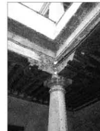
F.26 Detalle de capitel y zapatas, que han sido resanadas, para retardar el deterioro, causado por el paso de los años.
