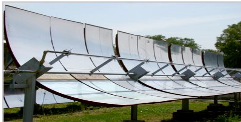
Figura 30 concentradores canal parabólico [31].
