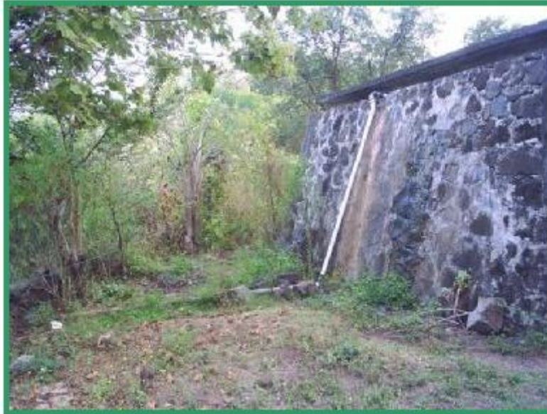
Tanque de Regulación ubicado en la zona baja de la Localidad, abastecido por una toma de la Línea de Alimentación a la Localidad de El Platanar.
