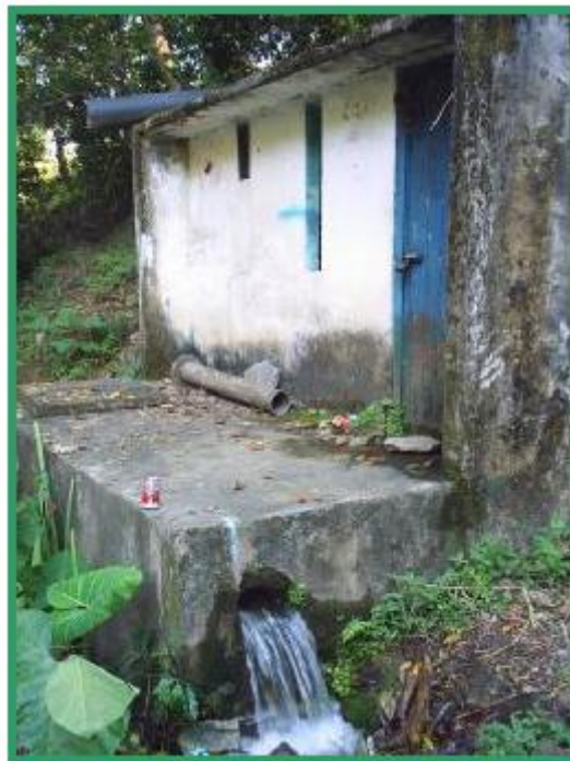
Estación de bombeo del actual sistema de abastecimiento de agua potable a la Localidad.
