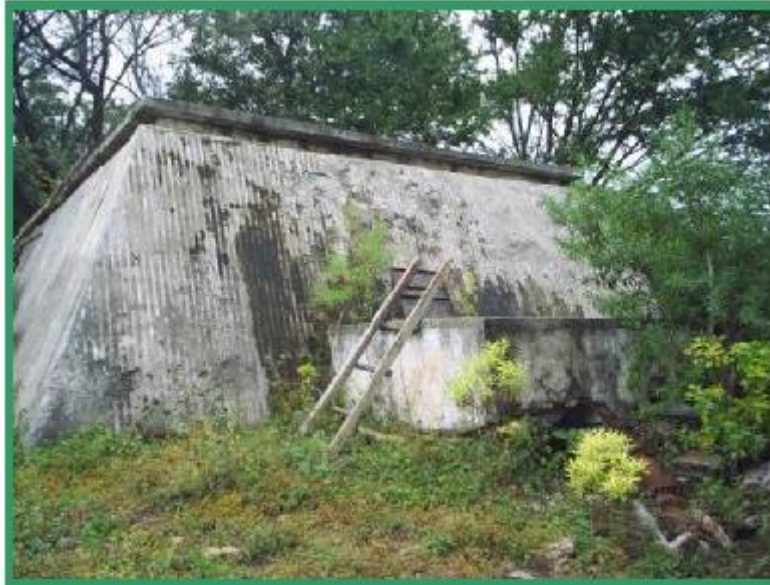
Tanque de Regulación existente a partir del cual, actualmente, se realiza el Abastecimiento a la Localidad.
