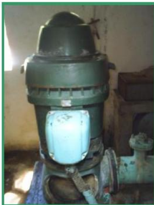
Equipo de Bombeo en el Interior de la Caseta.
