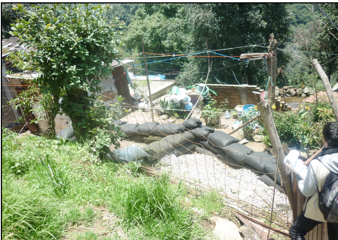
Foto 1: En esta imagen se aprecia la barra puesta con costales para evitar que los deslizamientos de tierra caigan sobre la vivienda.
