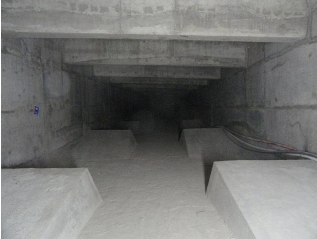
Figura 66 Bloques de anclaje de cables de servicio en el interior del túnel de cuerpo derecho
