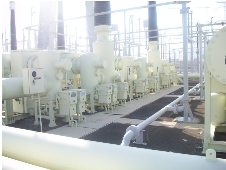
Fig. 5.- Fotografía Subestación Laguna Verde 230 kV
