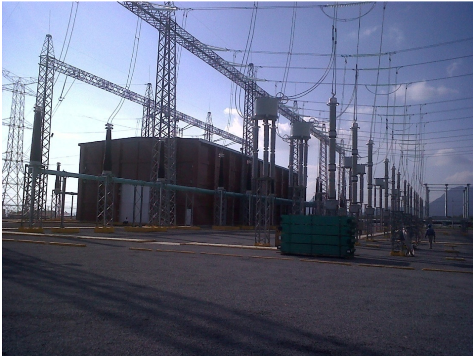
Fig. 4.- Fotografía Subestación Laguna Verde 400 Kv
