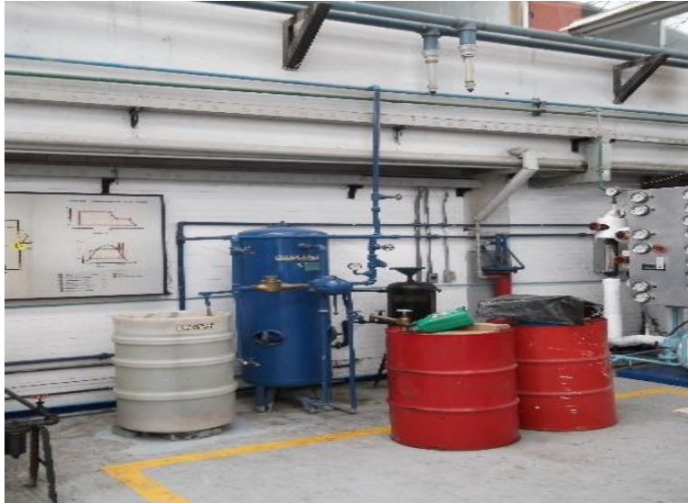
Figura 2.8. Tanque de tratamiento suavizador y suministro de combustible.
