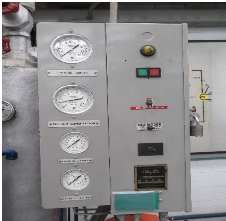
Figura 4.2. Instrumentos de medición del generador de vapor
