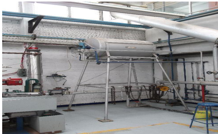
Figura 2.7. Tanque de condensados.
