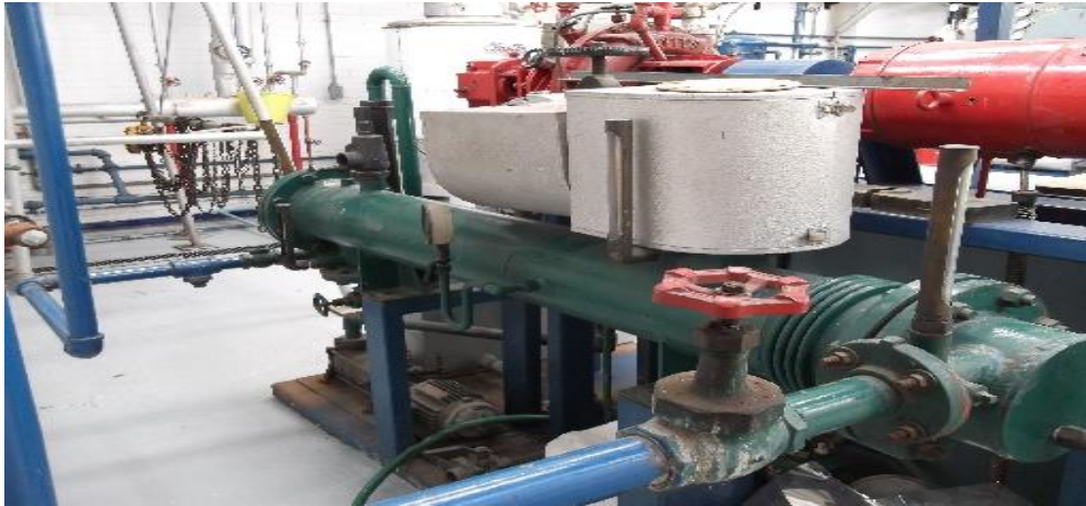
Figura 2.6. Intercambiador de calor.
