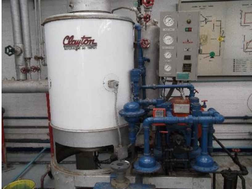
Figura 2.3. Generador de vapor
