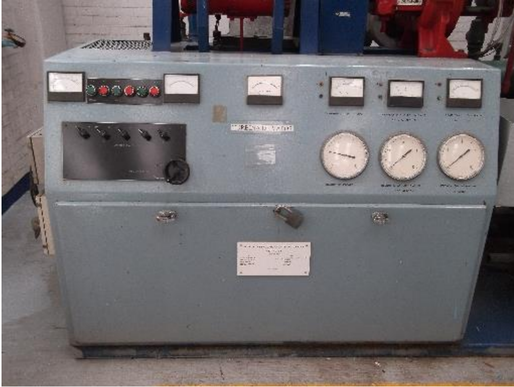
Figura 4.3. Instrumentos de medición de la turbina Coppus y el generador.
