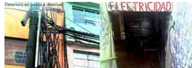
Deterioro en pasos a desnivel
