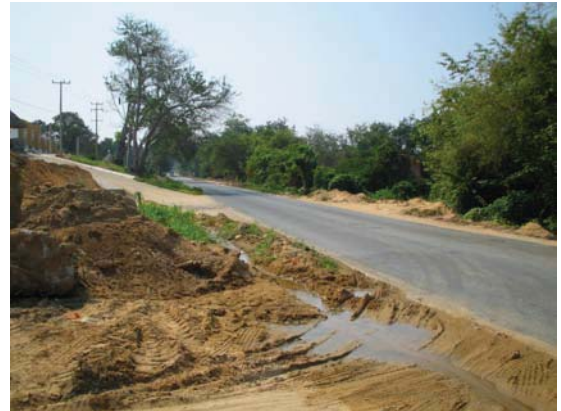
Tramo de la Carretera Federal No. 200 en mal estado.
