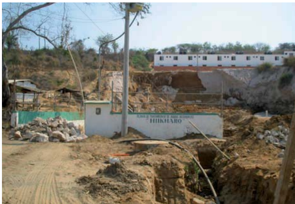
Planta de tratamiento de aguas negras, inservible
