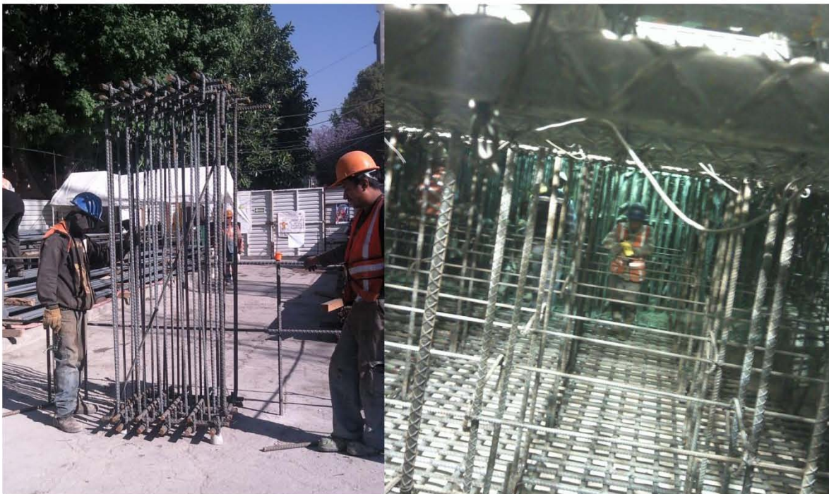
Img. 9. Habilitado del armado para la losa de fondo en la superficie y después a un trabajador en caminando entre el armado una vez colocado en su lugar definitivo.
