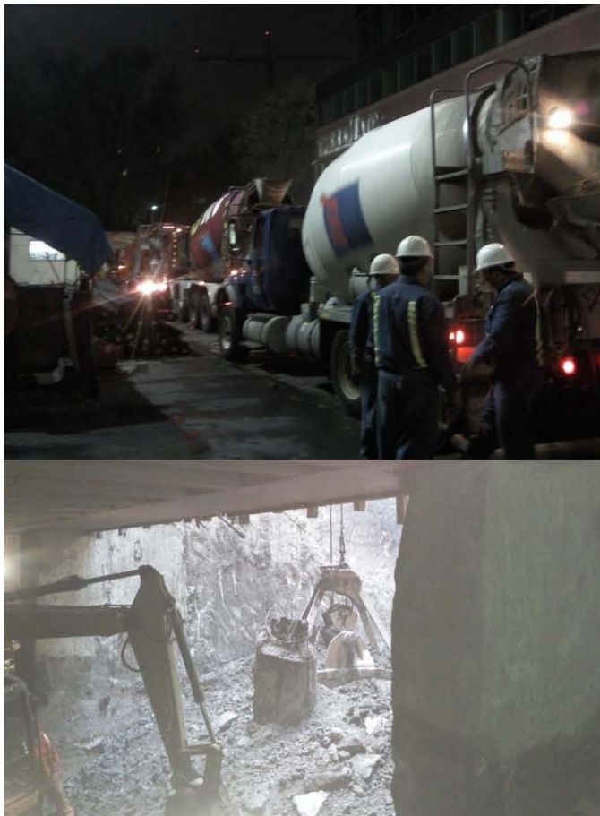
Img. 8. Arriba. Ollas de concreto esperando su turno para ser vaciadas durante la noche lluviosa del inicio del colado de la losa de fondo.
