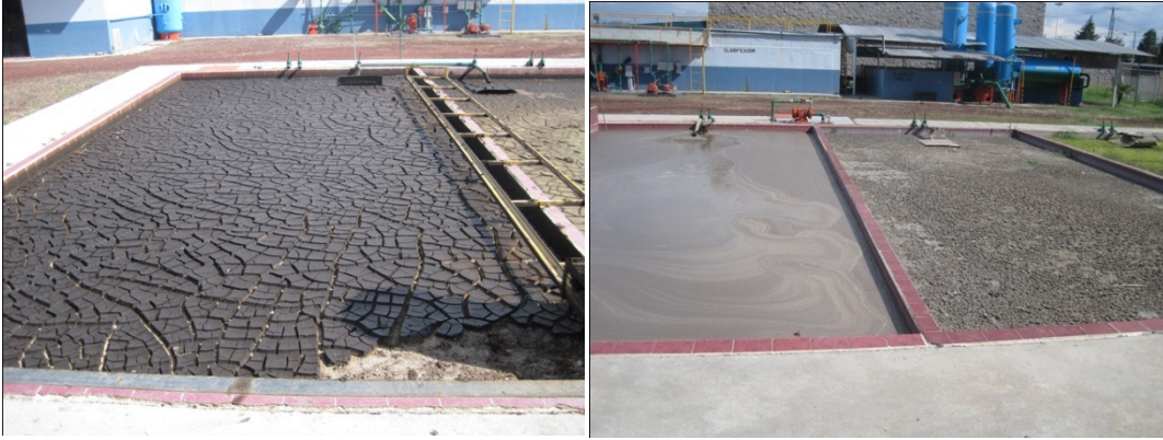
Figura 4.20 - Fotos de las fosas de secado de lodos de la PTAR.
