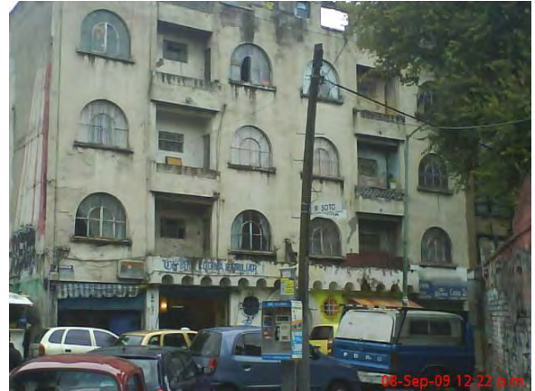
VISTA DEL DETRIORO DE LA MAYORIA DE LOS EDIFICIOS QUE EXISTEN EN LA COLONIA, ESTE EN PARTICULAR SE ENCUENTRA COLINDANTE CON EL RELINGO 3 Y ESTA CATALOGADO COMO PATRIMONIO A PESAR DE SU PESIMO ESTADO
