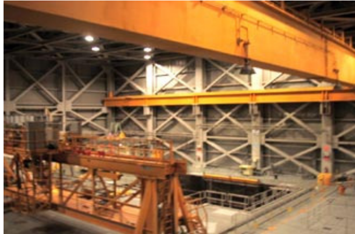
Figura 4.15 Plataforma de recarga II [Fuente: CFE, 2008b]
