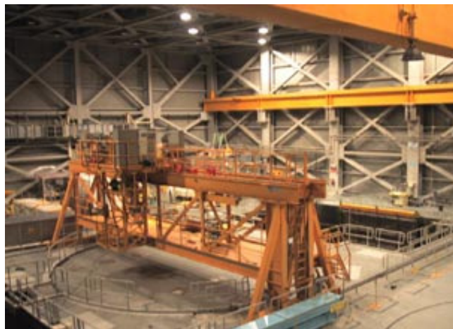
Figura 4.14 Plataforma de recarga I [Fuente: CFE, 2008b]
