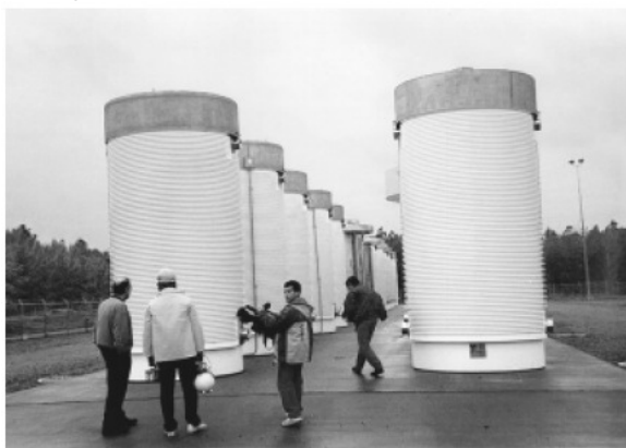
Figura 3.14 Campo de contenedores metálicos en la central de Surry (E.U.A.) [Fuente: Casanovas et al., 2000 ]
