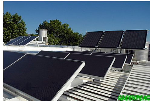
Img. 13 Paneles Solares.
