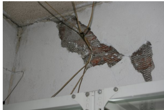
Img. 3 Deterioro de acabados
