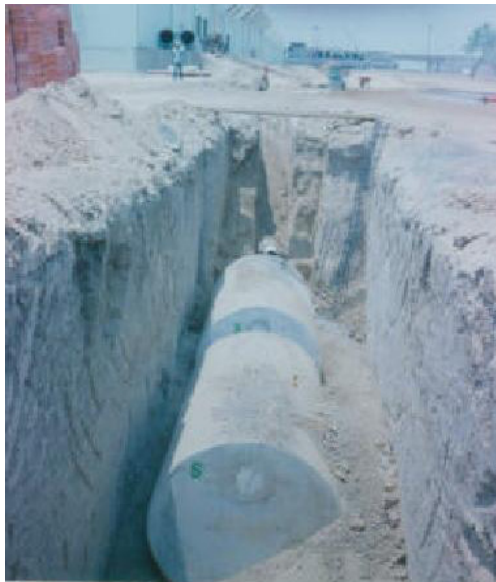
Img. 11 Filtros sanitarios
