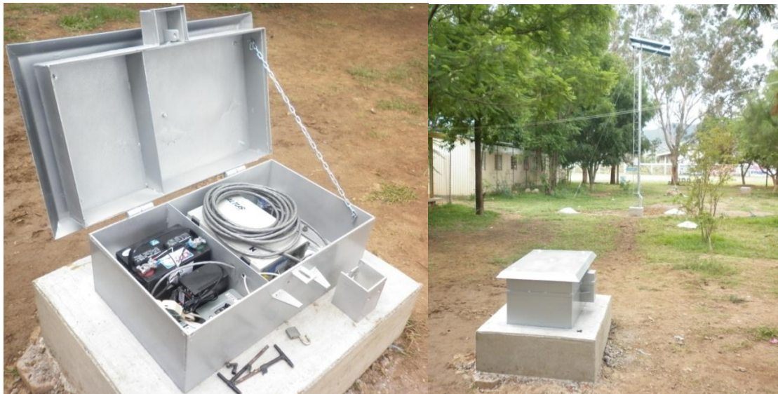
Figura III.24. Puesta en marcha de la estación OXXO
