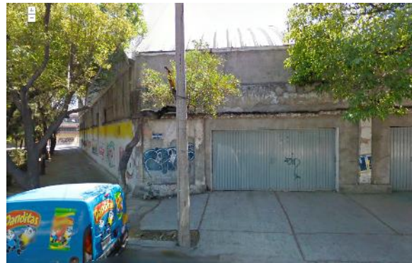
Edificio discordante en mal estado de conservación
