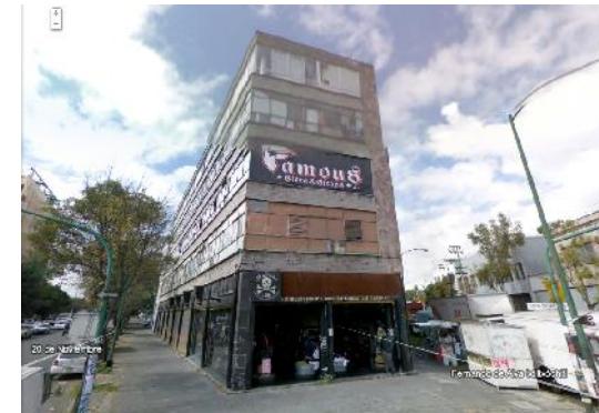
Edificio regular en mal estado de conservación, con alto potencial de reciclamiento
