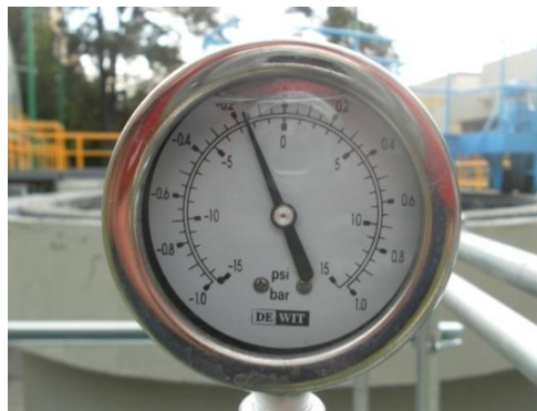
Figura AII.4 El manómetro en ciclo de operación (extracción de permeado)
