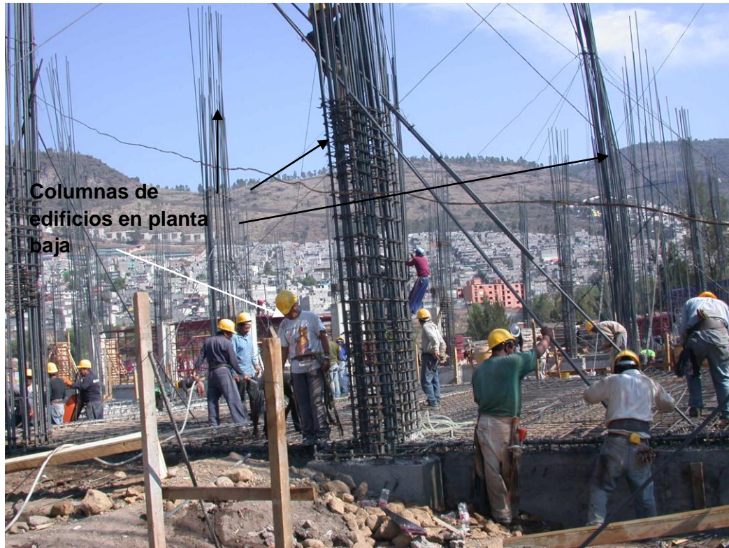
Foto 28 Colocación de acero de refuerzo en columnas de planta baja de edificio en estudio
