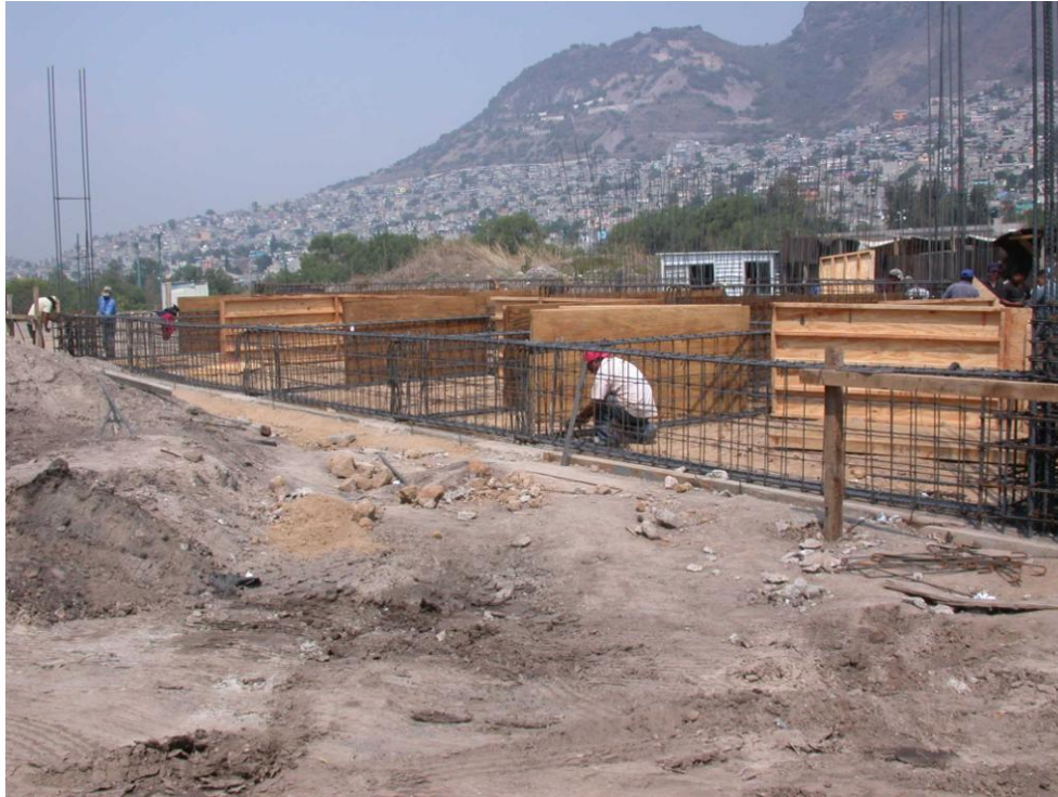
Foto 19 Armado de acero y cimbra para contra trabes y dados de cimentación
