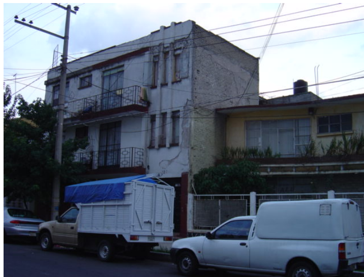
Del lado izquierdo observamos la colindancia norte, la cual es una vecindad bastante deteriorada estructuralmente, siendo un riesgo durante el desarrollo de la obra.
