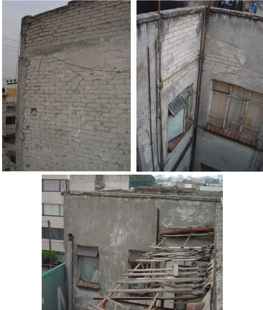
Fotos del inmueble vecino que demuestra las condiciones en que se encontraba el edificio.
