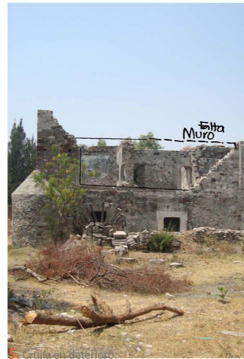
5. Crujía en deterioro.
