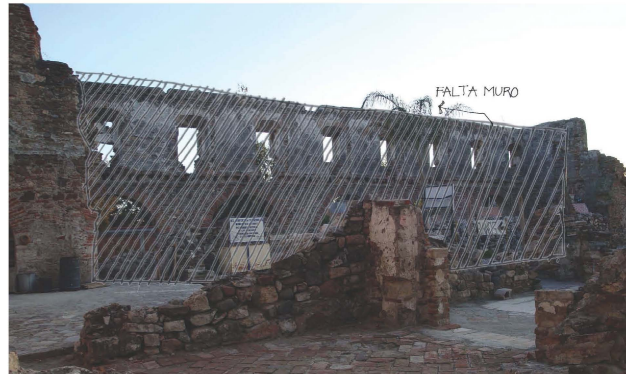
Convento franciscano lado poniente, patrimonio en deterioro progresivo, 2012
