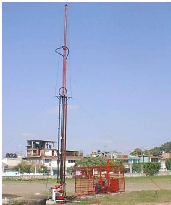
Figura 3.4. Unidad de Bombeo Mecánico hidroneumática Tieben.
