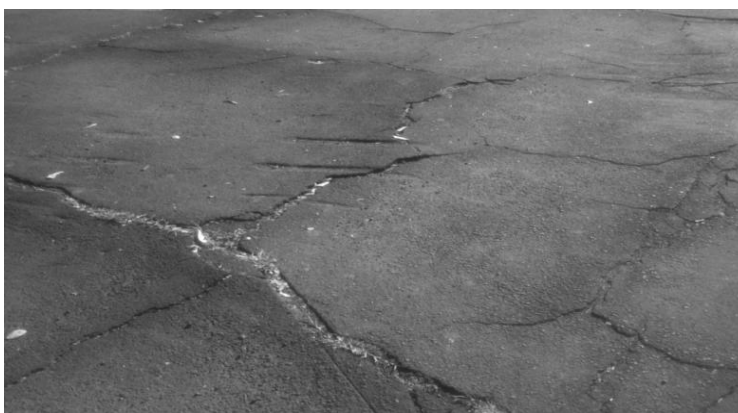
Figura. 4 cap.III tipos de fallas por observación grietas por reflexión estacionamiento de las FES Aragón
