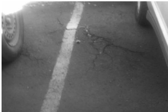
Figura. 8 cap.III tipos de fallas por observación bufamientos estacionamiento de las FES Aragón
