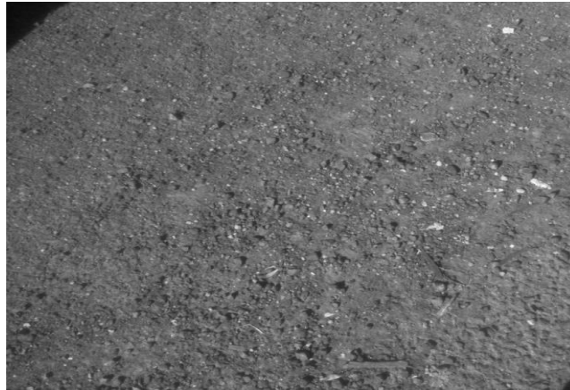
Figura. 9 cap.III tipos de fallas por observación desintegraciones estacionamiento de las FES Aragón
