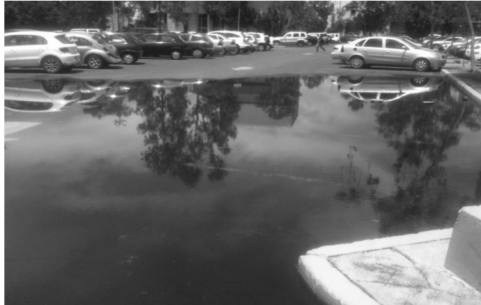
Figura. 7 cap.III tipos de fallas por observación hundimientos estacionamiento de las FES Aragón
