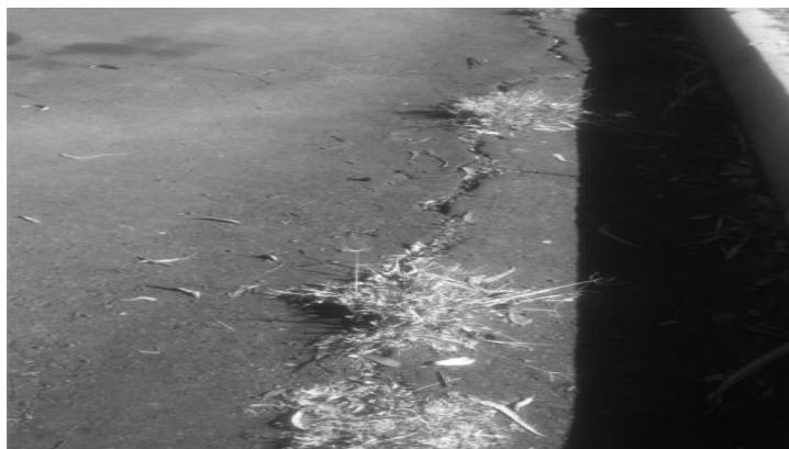
Figura. 2 cap.III tipos de fallas por observación grietas en los bordes estacionamiento de las FES Aragón
