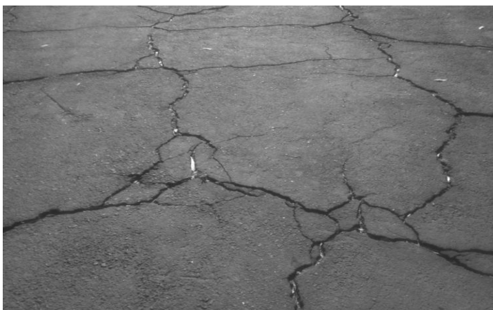
Figura. 5 cap.III tipos de fallas por observación grietas por contracción estacionamiento de las FES Aragón
