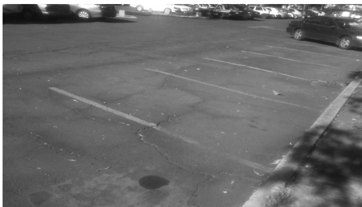
Figura. 3 cap.III tipos de fallas por observación grietas longitudinales estacionamiento de las FES Aragón
