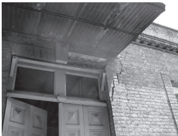
[43] Grietas y agregados. Foto. Laureana Martínez Figueroa 2011
