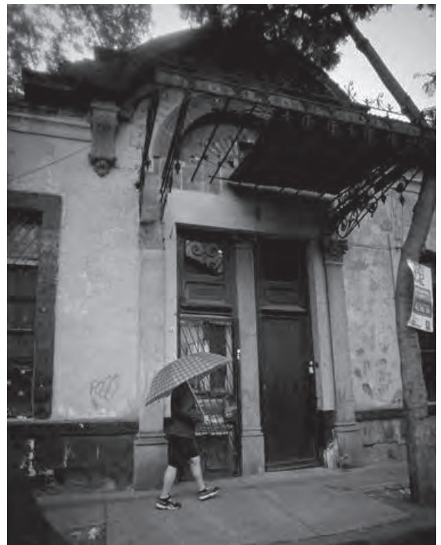
[6] Deterioro de la fachada del Teatro Bernardo García en Salvador Díaz Mirón No.69. Foto: Laureana Martínez 2013.
