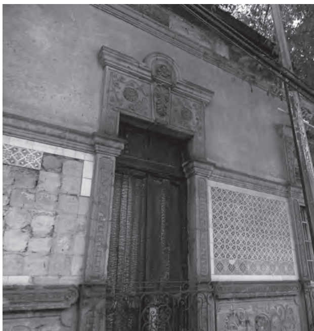
[2] Fachada que muestra diversos deterioros: desprendimiento de acabados, puertas y ventanas carbonizadas y herrería oxidada entre otros. Foto: Laureana Martínez 2013.
