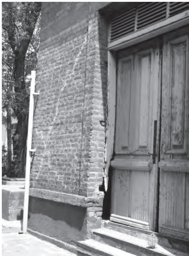
[44] Deterioro del edificio. Presencia de grietas diagonales cruzadas en los muros de tabique. Foto. Laureana Martínez Figueroa 2011
