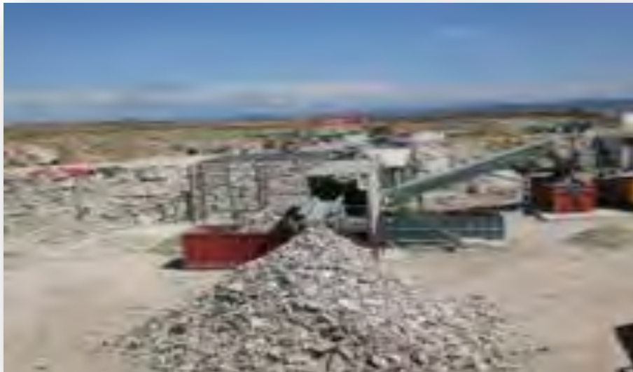
Figura 5.3 Planta de tratamiento de los RCyD.
