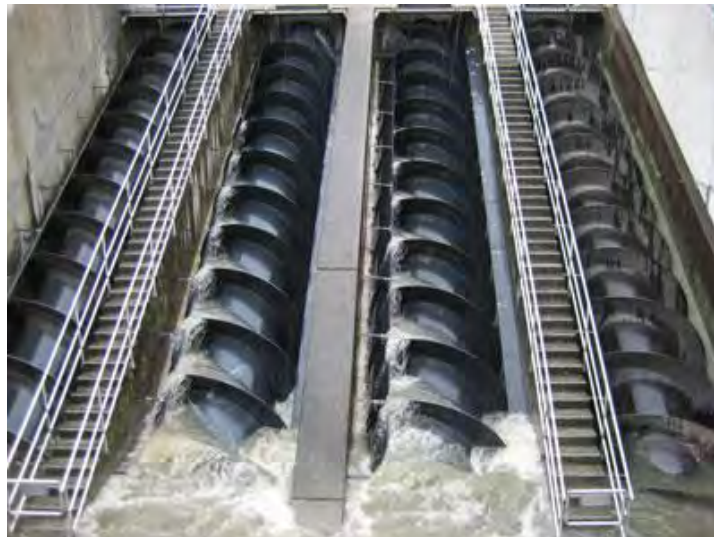
Figura 1.7 Bombas de tornillo
