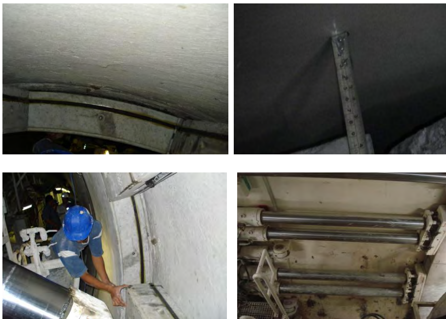
Traslapes y escalones
