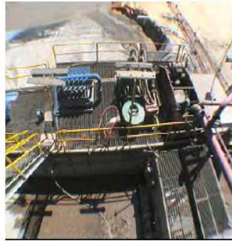
Sistema de lodo
