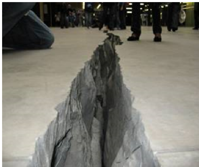
Fig. 2.6 Cada vez es más frecuente la aparición de grietas en el D.F.
