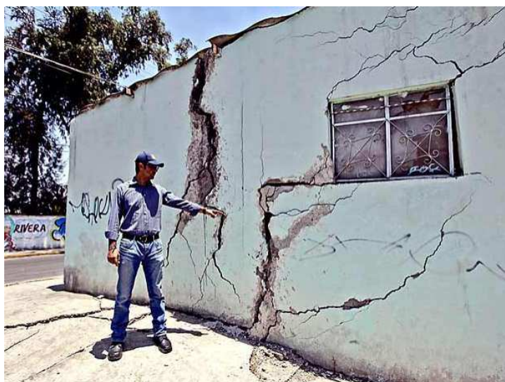
Fig.2.5 Agrietamientos en vivienda de Iztapalapa.
