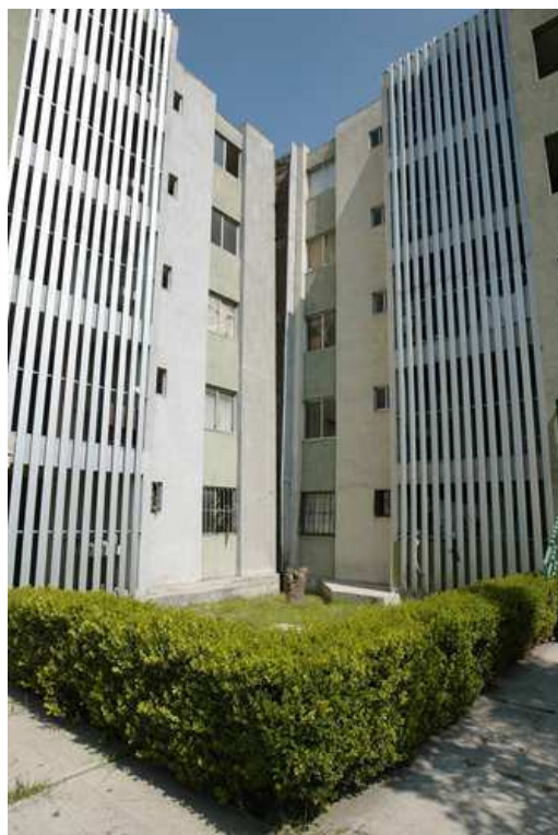
Fig. 3.7 Desplome de edificios del conjunto Patera Vallejo
