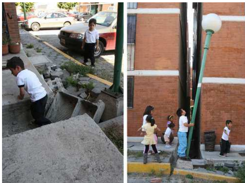
Fig.3.5 Desplome y agrietamientos en el conjunto La Concordia Zaragoza
