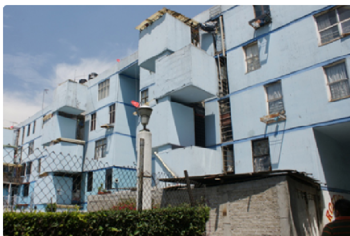
Fig. 3.8 Inestabilidad en los patios de servicio en edificios del conjunto El Rosario
