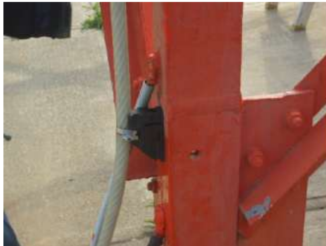
Figura 4.6 Modo de sujeción del cable del pararrayos
