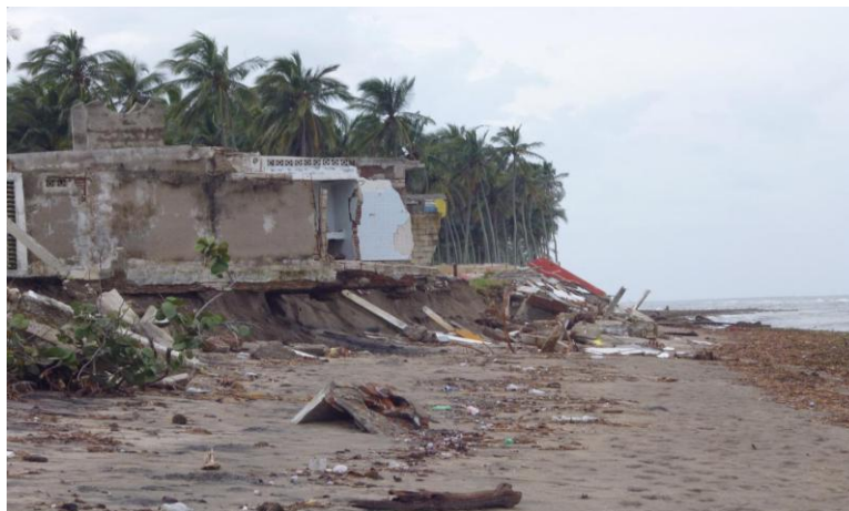
Figura 99. Casas afectadas por la erosión en Barra de Tupilco.
