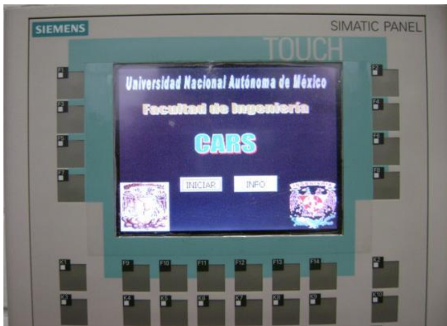
Figura 4.42. Panel de operado con HMI.
