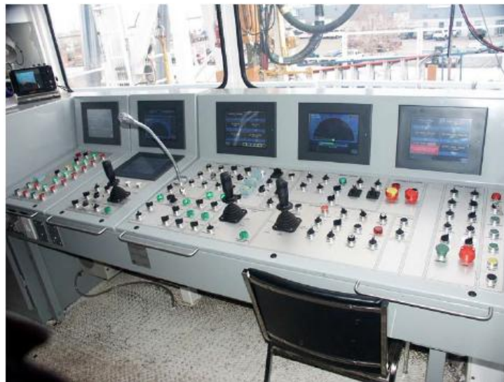
Figura 4.10. Centro de control del perforador (DCC) (TESCO).
