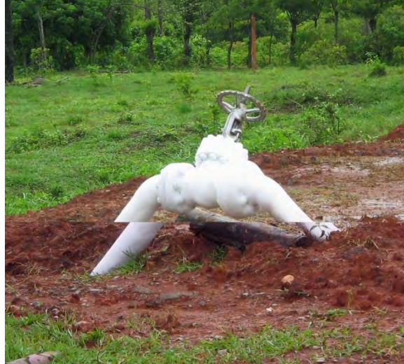
Fig. 218.-Congelamiento de la válvula de seccionamiento.
