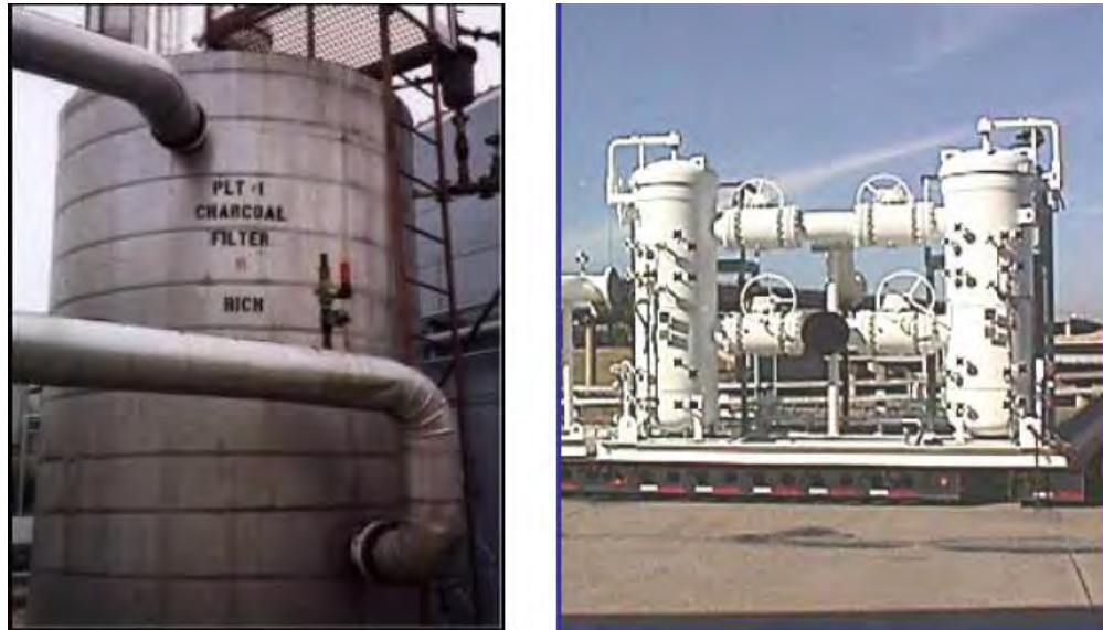
Fig. 44.- Filtros de glicol
