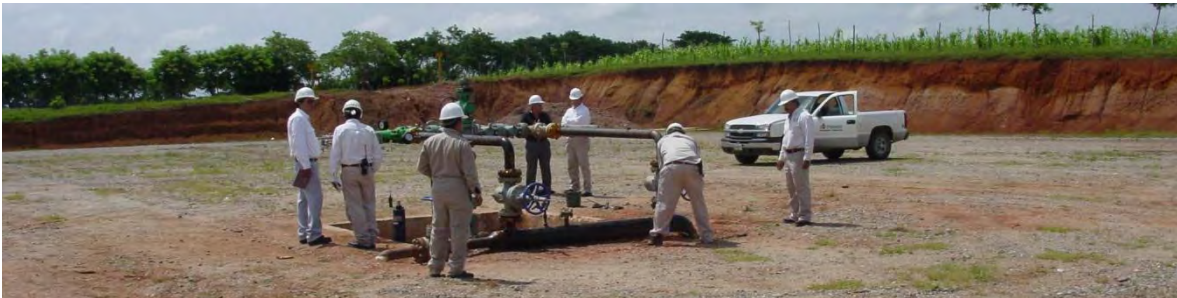
Fig. 232.- Colocación de Válvulas de uso severo en el pozo Mundo Nuevo 201.
