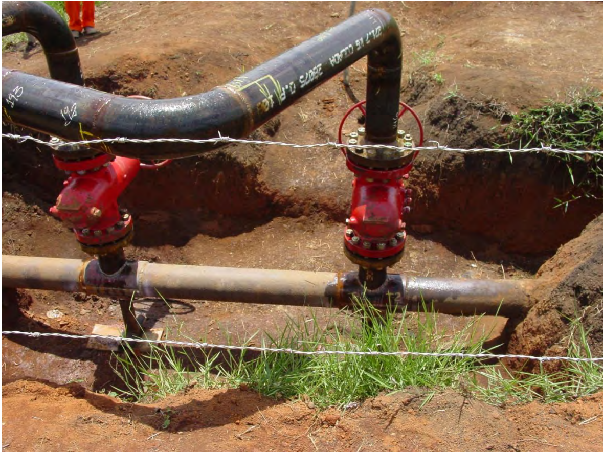
Fig. 236.- Área de interconexión en el pozo Mundo Nuevo 201.
