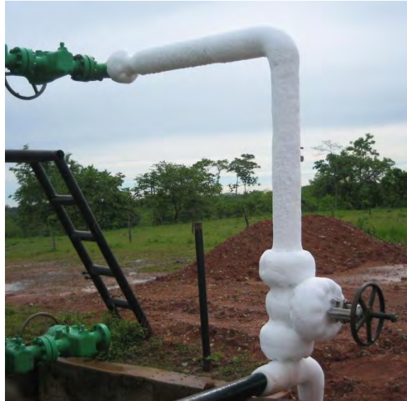
Fig. 216.-Bajante y parte del cabezalito congelado. Fuente.- Coordinación de Construcción y Mantenimiento. A.I.M.
