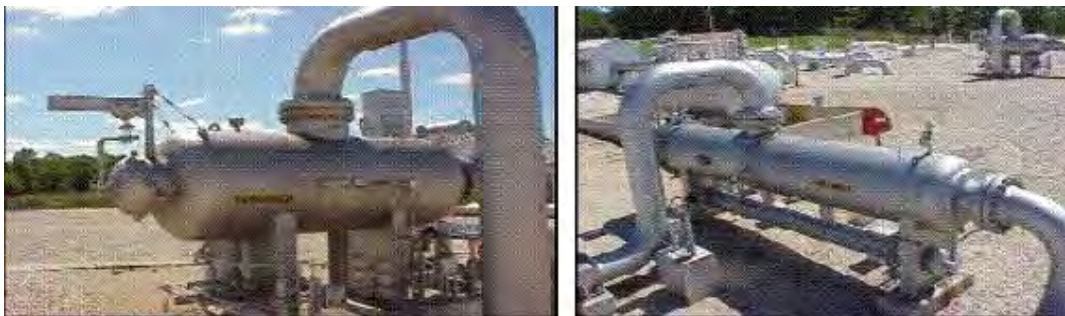
Fig.41.- Filtro coalescedor y separadores de líquidos del gas húmedo.
