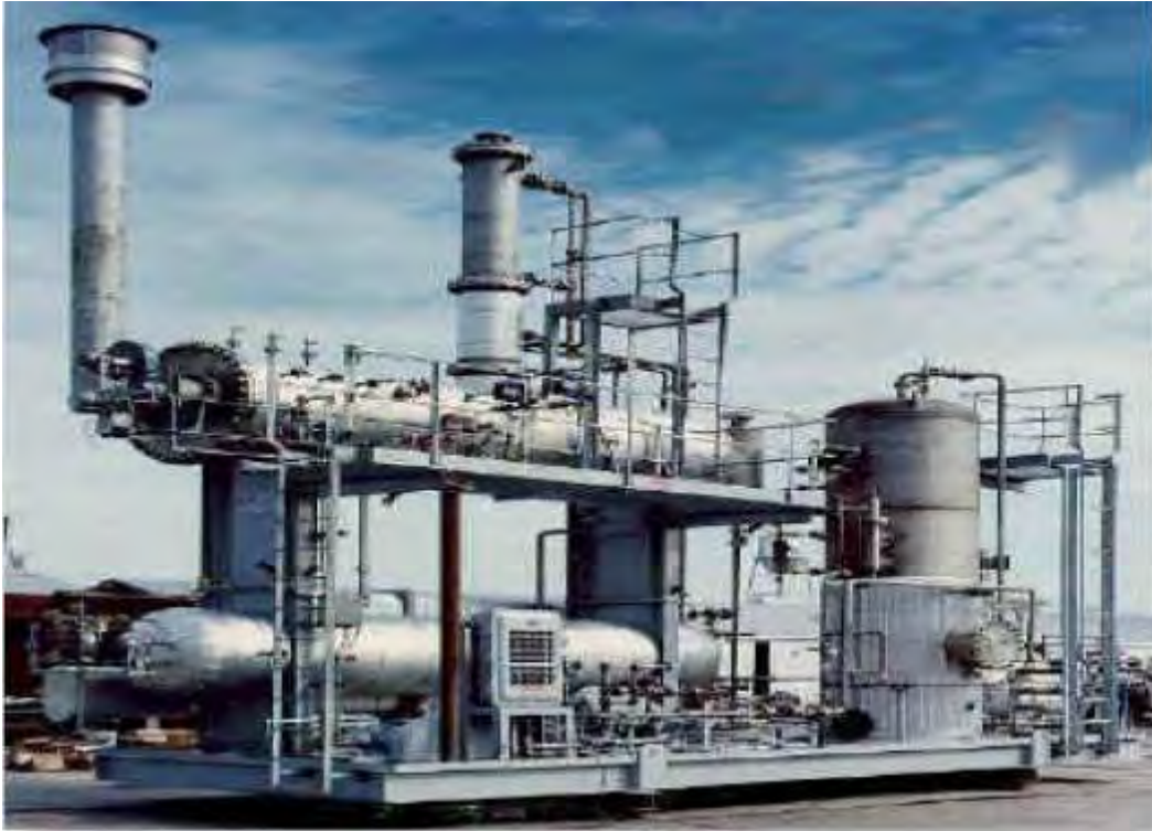
Fig. 42.- Torre contactora para regeneración del glicol y deshidratación del gas
