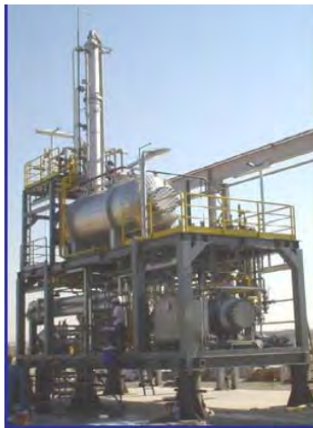
Fig.50.- Columna de destilación. Fuente.- Copyright 2007, NCT, Energy Group. All rights reserved .
