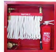
Imagen que muestra el Gabinete de protección contra incendio
