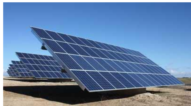
Figura 8.12 Panel de Celdas Fotovoltaicas en Operación Fuente: Internet
