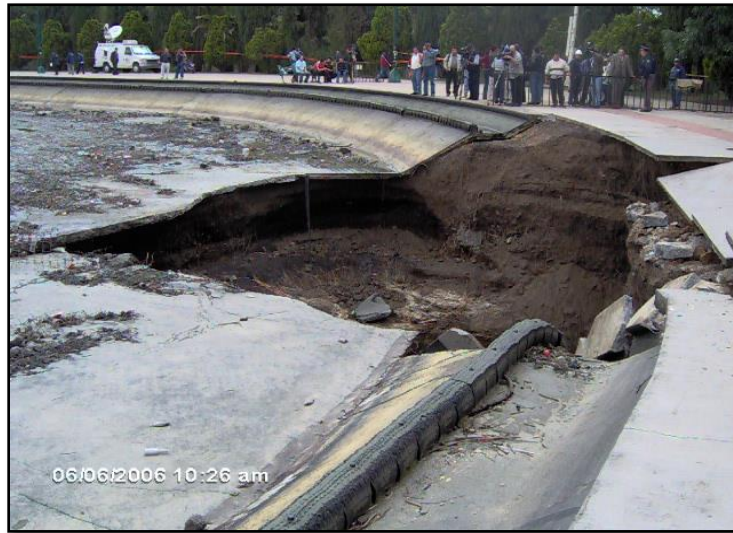
Fotografía 1.- en junio de 2006 a raíz del colapso en la cimentación de la estructura del lago mayor se ocasiono un boquete en el subsuelo que erosiono y socavo los primeros metros.*
