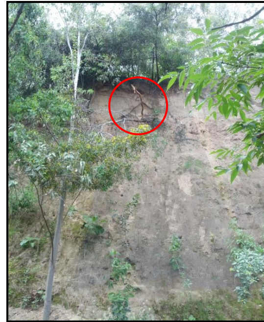
Fotografía 3.- se muestra la parte más alta del talud # 1 que corresponde a 18 metros. En el círculo rojo se aprecia las raíces de la vegetación que afecta al talud provocando desprendimientos de bloques.
