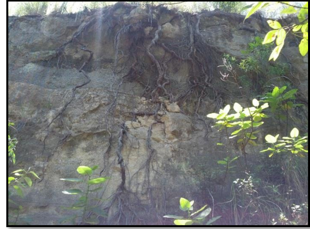
Fotografía 10: se muestra el efecto que tienen las raíces de árboles y plantas sobre las unidades del talud escuela.
