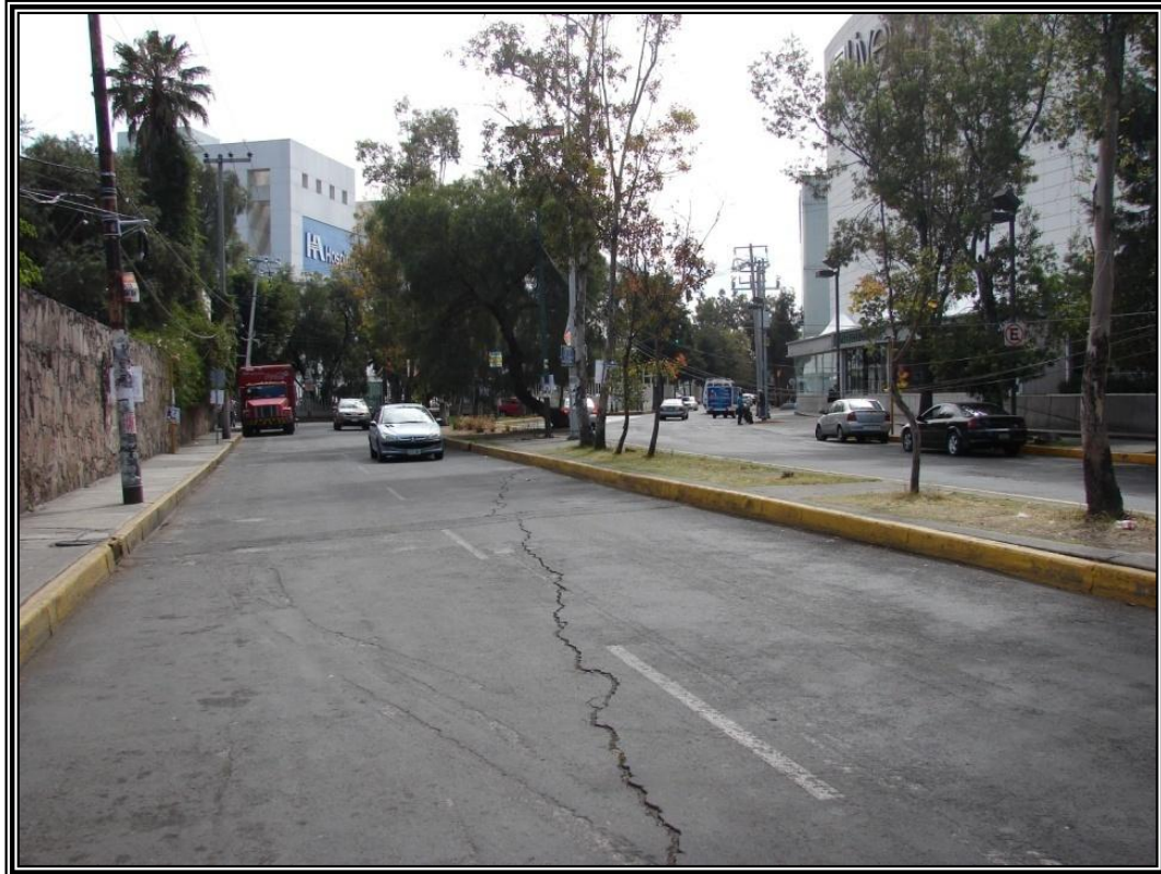
Figura 3.62. Fotografía que muestra daños en el pavimento de la calle Colector 13, en la colonia Lindavista.
