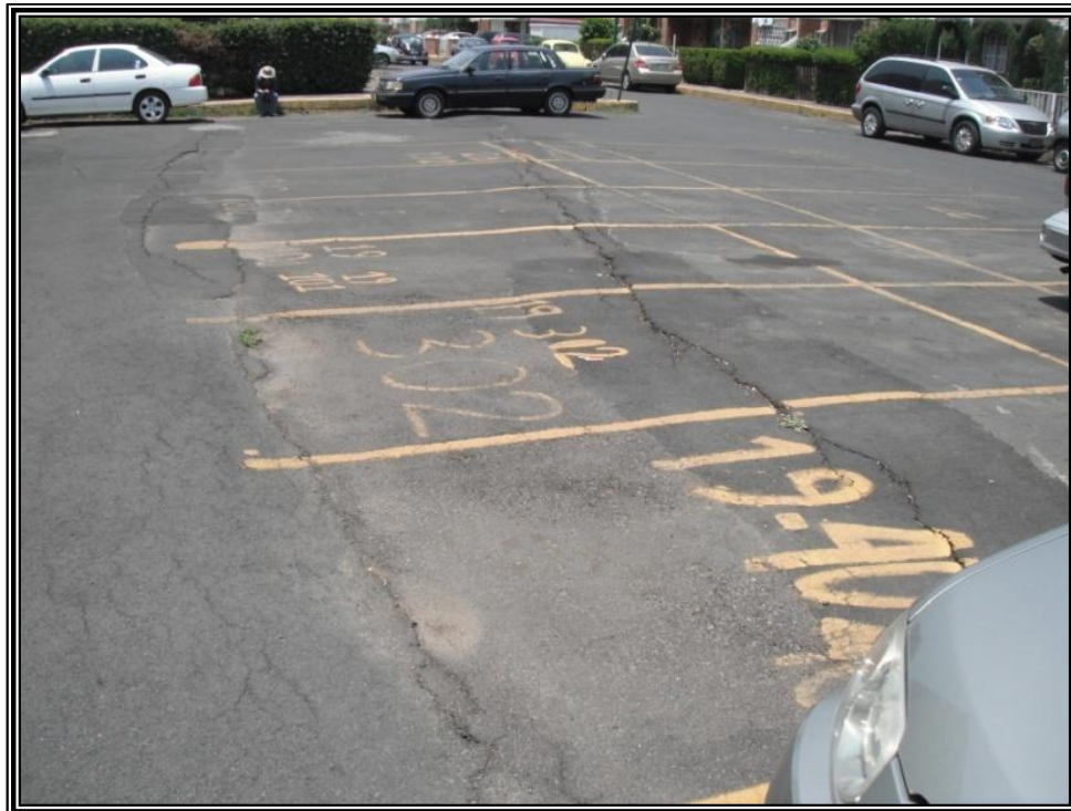
Figura 3.83. Imagen que muestra el daño en el pavimento de la calle Retorno 1, ocasionado por fracturas.
