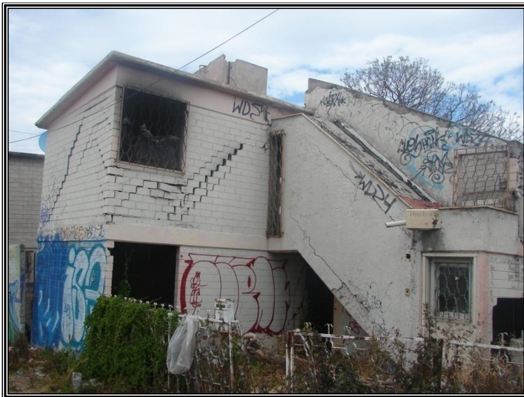
Figura 6.2. Ejemplo de los daños estructurales en la colonia Popular Ermita Zaragoza.
