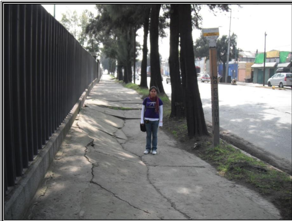
Figura 3.57. Fotografía que muestra el salto estructural de una falla normal en la calle Poniente 128, en la colonia Nueva Vallejo.
