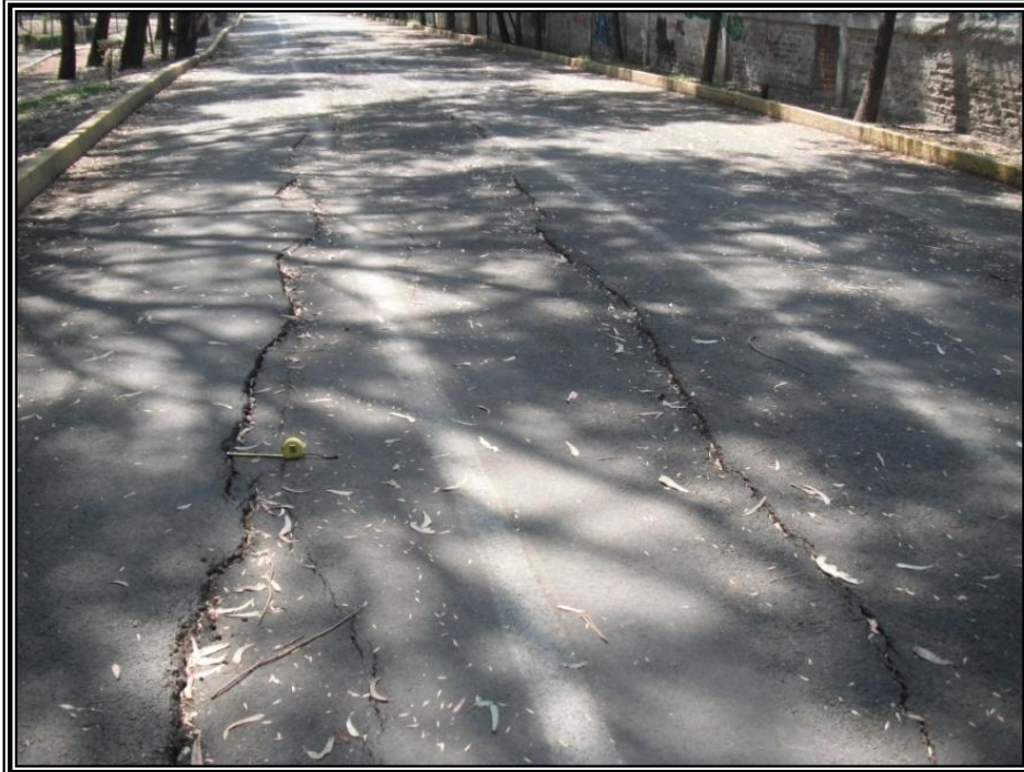
Figura 3.87. Imagen que muestra los daños en el pavimento de la Alameda Norte, Pueblo Santa Bárbara.
