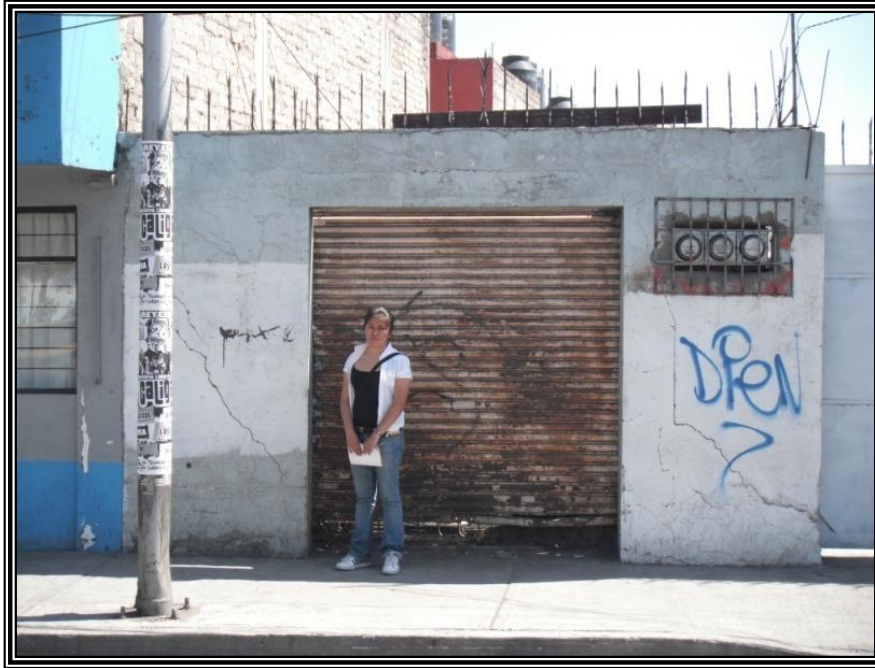
Figura 3.41. Imagen que muestra el daño en las construcciones de la colonia Tepalcates.
