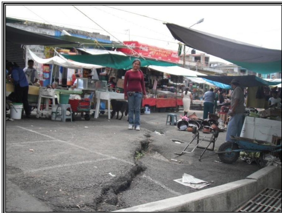
Figura 3.94. Imagen que muestra el daño en la calle Medellín, ocasionado por la falla normal en San Andrés Mixquic.
