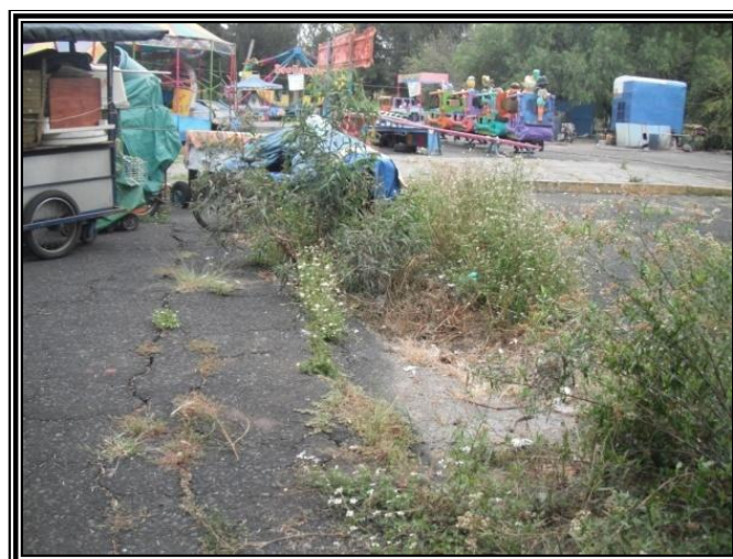
Figura 3.53. Imagen que muestra los daños ocasionados en el pavimento por una falla normal, en el Bosque de Aragón.
