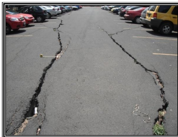
Figura 6.19. Ejemplo de los daños estructurales en la Alameda del Norte, Pueblo Santa Bárbara.
