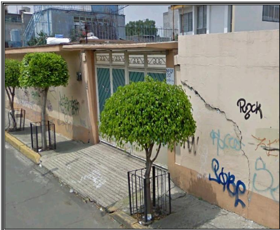
Figura 3.46. Fotografía que muestra los daños ocasionados en una vivienda de la calle Javier Mina, en la colonia Santa Cruz Meyehualco.
