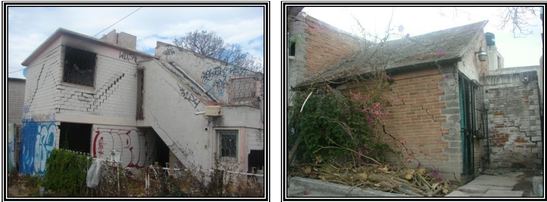
Figura 3.21. Imagen que muestra dos casas con severos daños estructurales en la colonia Popular Ermita Zaragoza.
