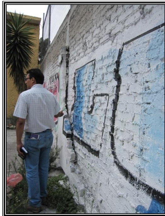
Figura 3.33. Imagen que muestra el daño en una pared en calle Reforma, en la colonia Lomas de San Lorenzo.
