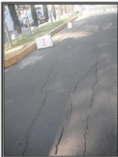
Figura 6.15. Ejemplo de los daños estructurales en la colonia Jardines de Coyoacán.
