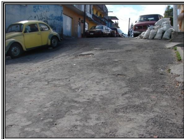
Figura 6.21. Ejemplo de los daños estructurales en la colonia Barrio Norte.
