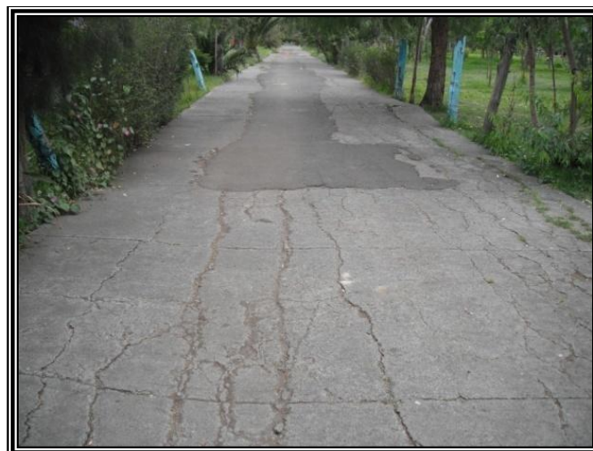
Figura 3.52. Imagen que muestra los daños en el pavimento de las calzadas del Bosque de Aragón, en Gustavo A. Madero.
