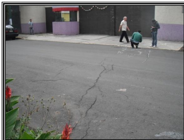
Figura 6.17. Ejemplo de los daños estructurales en Barrio San Marcos.
