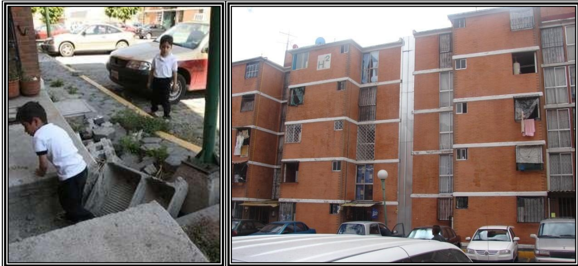
Figura 6.1. a) Ejemplo de los daños estructurales en la Unidad Concordia Zaragoza, b) aun con la nivelación es un sitio vulnerable.
