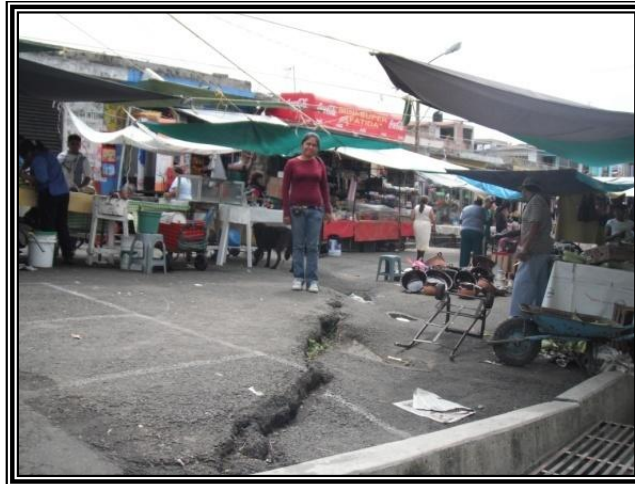
Figura 6.20. Ejemplo de los daños estructurales en el Pueblo San Andrés Mixquic.
