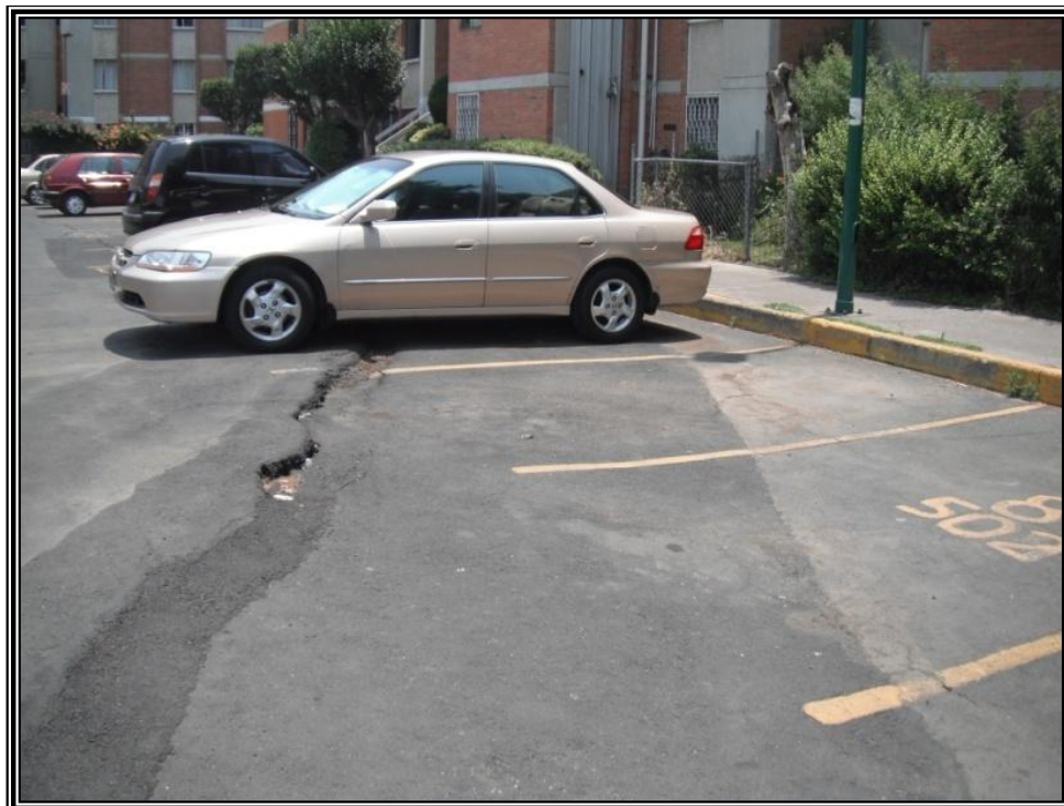
Figura 3.84. Imagen que muestra el daño en el pavimento de la calle Retorno 1, ocasionado por una falla normal.
