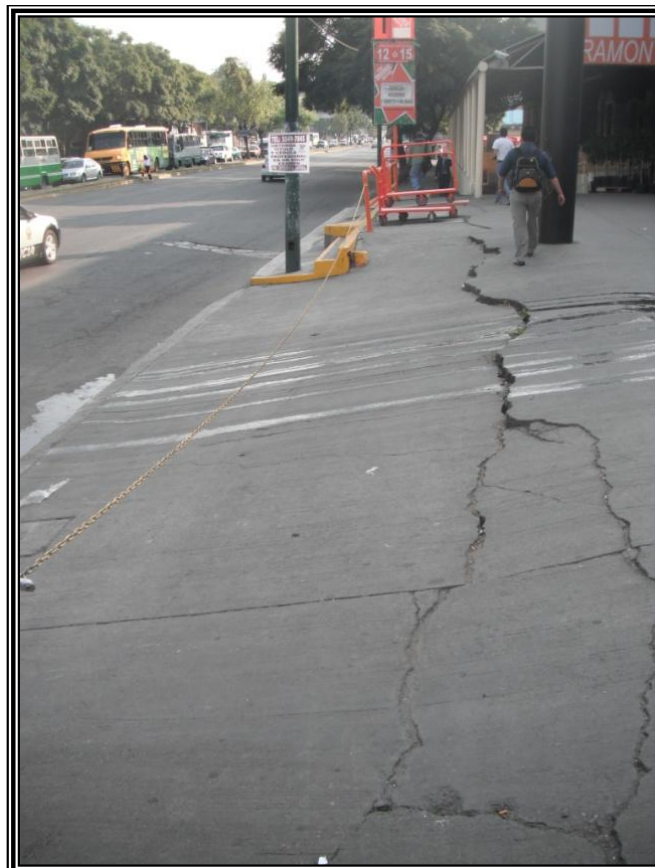
Figura 3.73. Imagen que muestra los daños en la banqueta de la Avenida Canal de Miramontes, colonia Los Girasoles.
