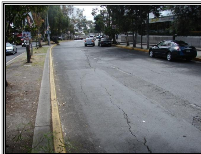
Figura 6.10. Ejemplo de los daños estructurales en la calle Colector 13, colonia Lindavista.
