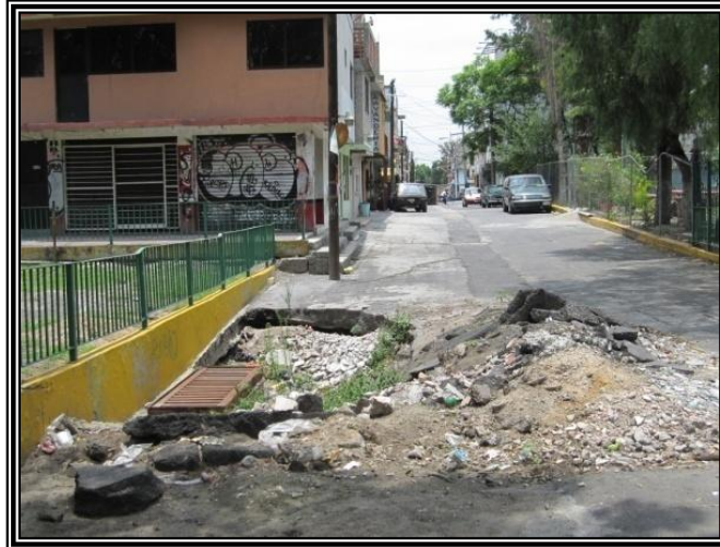
Figura 6.7. Ejemplo de los daños estructurales en la colonia Santa Cruz Meyehualco.
