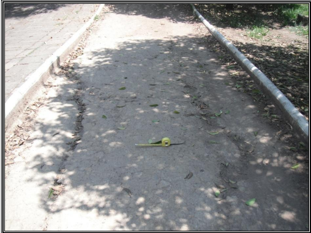
Figura 3.91. Fotografía que muestra las fracturas en la pista de corredores en la Alameda Norte, Pueblo Santa Bárbara.
