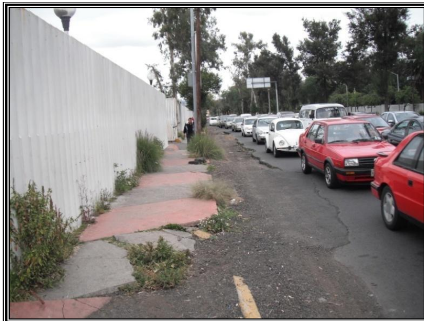
Figura 3.54. Imagen que muestra los daños ocasionados en el pavimento de José Loreto Fabela, en Gustavo A. Madero.
