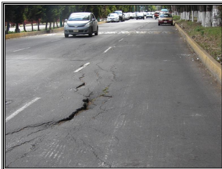
Figura 6.12. Ejemplo de los daños estructurales en la calle Wilfrido Massieu, en las inmediaciones del IPN.
