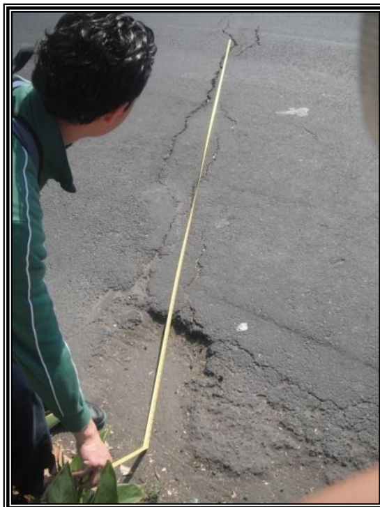
Figura 1.4.6. Medición de la longitud de fracturas en el pavimento de Av. México, Xochimilco D.F.
