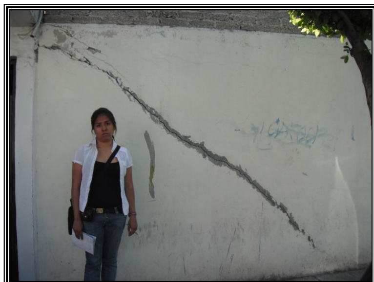
Figura 6.6. Ejemplo de los daños estructurales en la colonia Reforma Educativa.
