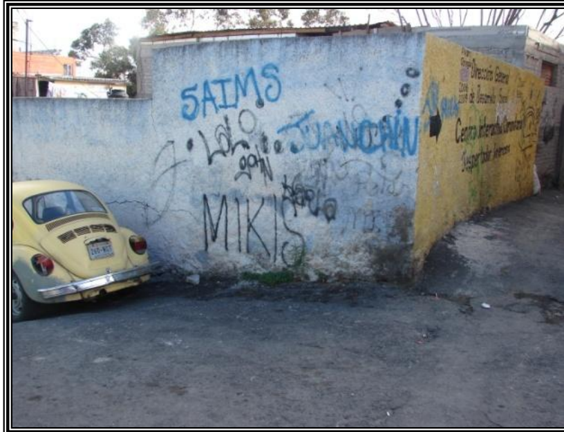
Figura 3.100. Imagen que muestra el daño en la pared de una casa en calle Despertador Americano, en la colonia Barrio Norte.
