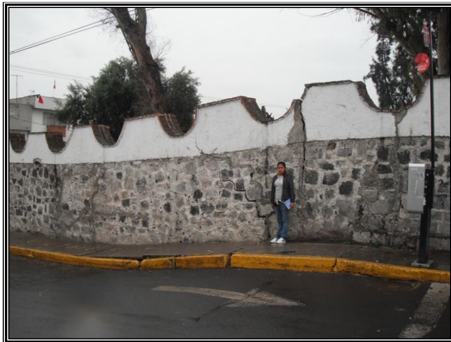
Figura 3.95. Imagen que muestra el daño en la barda de la iglesia principal de San Andrés Mixquic.
