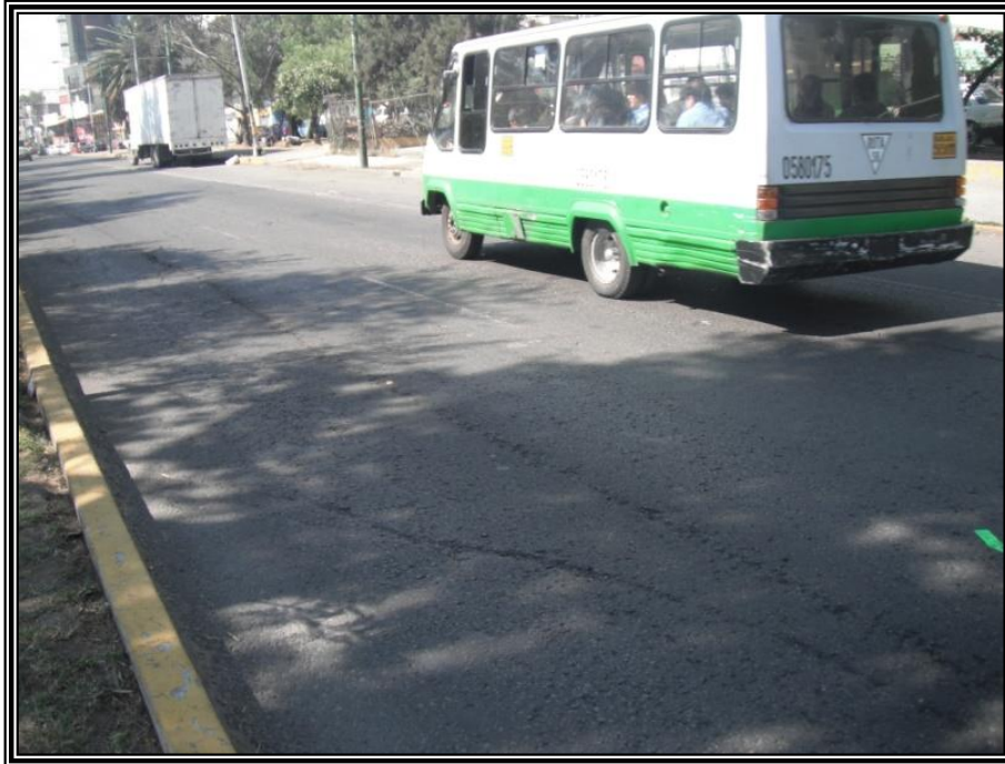
Figura 3.67. Fotografía que muestra una fractura en el pavimento de la calle José Loreto Fabela, en la colonia Ampliación Casas Alemán.
