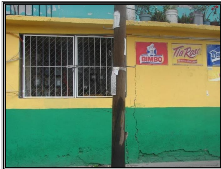
Figura 3.19. Imagen que muestra daños en una casa ubicada en la calle Niño Artillero, colonia Popular Ermita Zaragoza.
