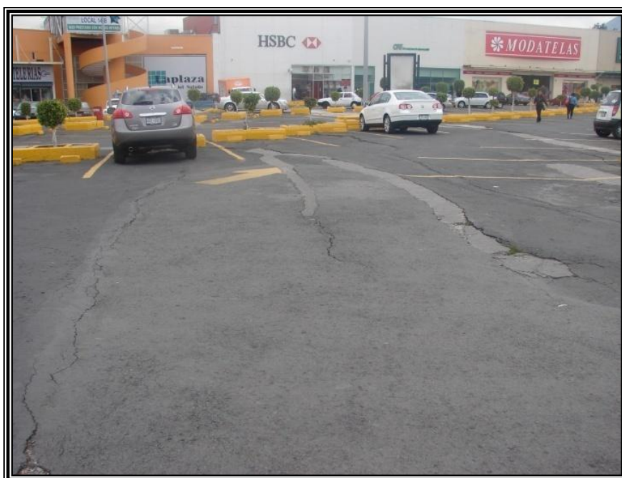
Figura 3.14. Imagen que muestra las fracturas en el estacionamiento de la plaza comercial El Salado, Concordia Zaragoza.
