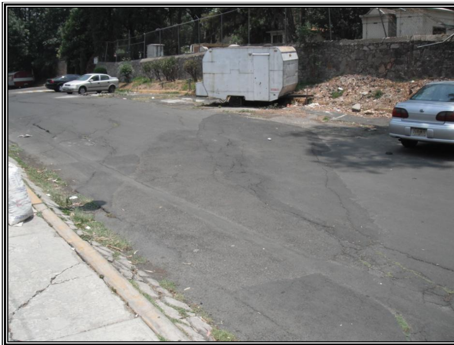
Figura 3.82. Imagen que muestra el daño en el pavimento en Mártires de Río Blanco, U. H. Rinconada del Sur.
