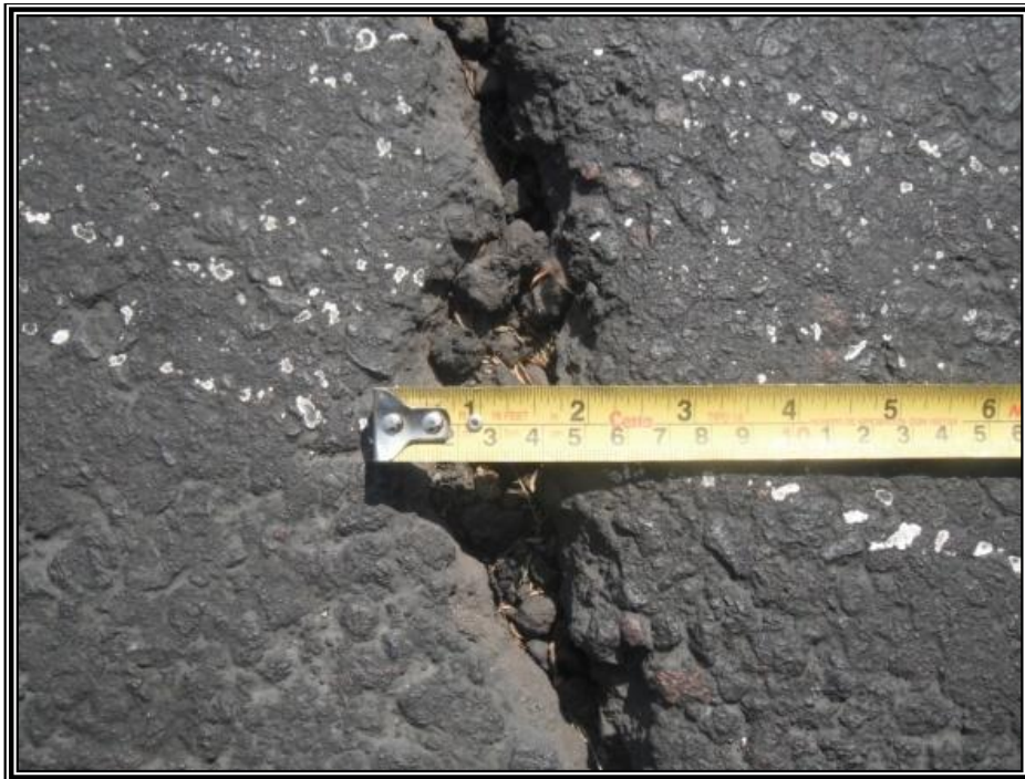
Figura 1.4.7. Medición de la abertura de una fractura en el pavimento de Av. México, Xochimilco D.F.
