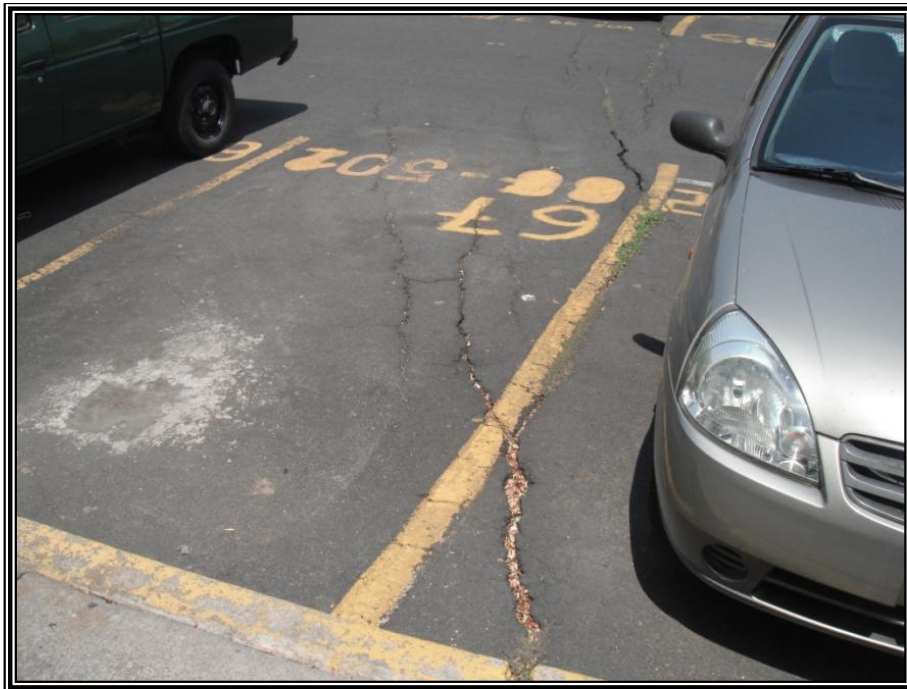
Figura 3.85. Imagen que muestra el daño en el pavimento de la calle Retorno 3, ocasionado por fracturas.
