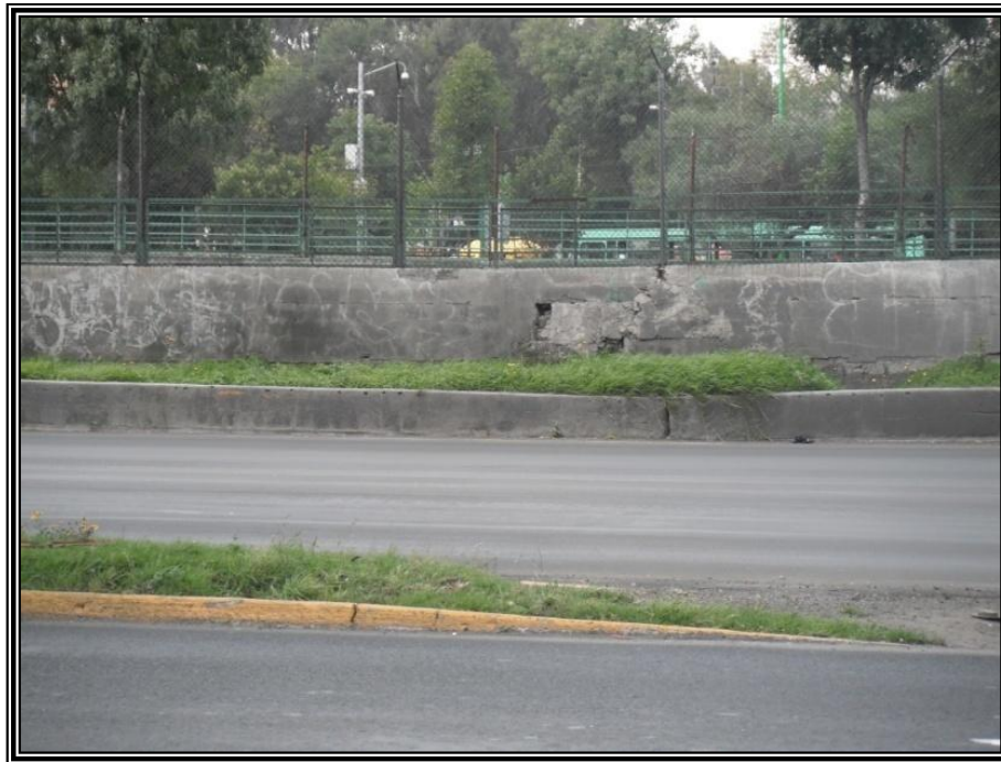
Figura 3.60. Fotografía que muestra el daño en las bardas del ST metro y la forma irregular del terreno, en el Eje Central Lázaro Cárdenas, en la colonia Valle del Tepeyac.
