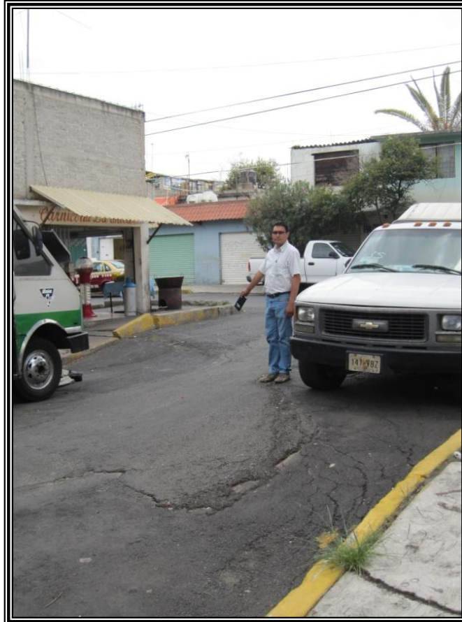
Figura 3.50. Se observan los daños ocasionados en el pavimento de la calle Leandro Valle, en la colonia Jacarandas.
