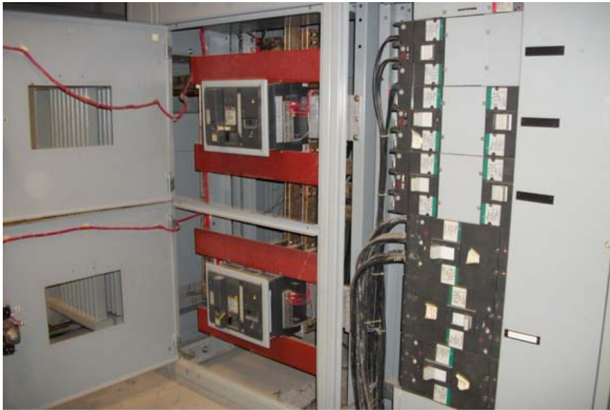
Fig. 3.4 Tablero de transferencia y tablero de emergencia.
