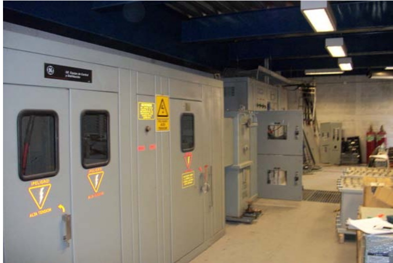
Fig. 3.1 Subestación eléctrica compacta de 750 KVA servicio interior
