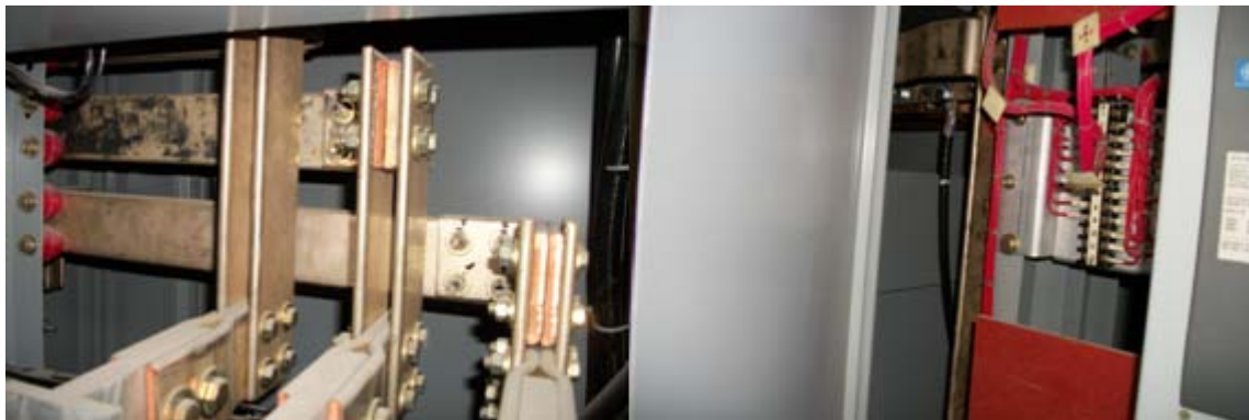
Fig. 3.3 Acoplamiento existente entre transformador de 750KVA y tablero de transferencia. Esta realizado por barras de cobre de 2000 amperes
