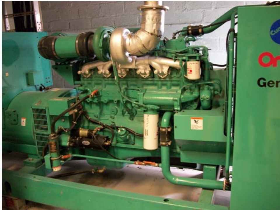
Fig. 3.6 Planta de emergencia de 350KW a 220/127 Volts. Factor de potencia=0.8, 60Hz
