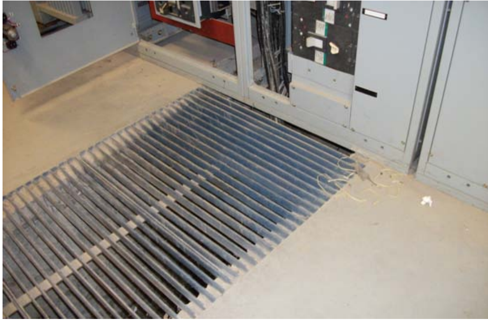
Fig. 3.8 Trinchera eléctrica bajo tableros para direccionar cables a tuberías bajo piso.
