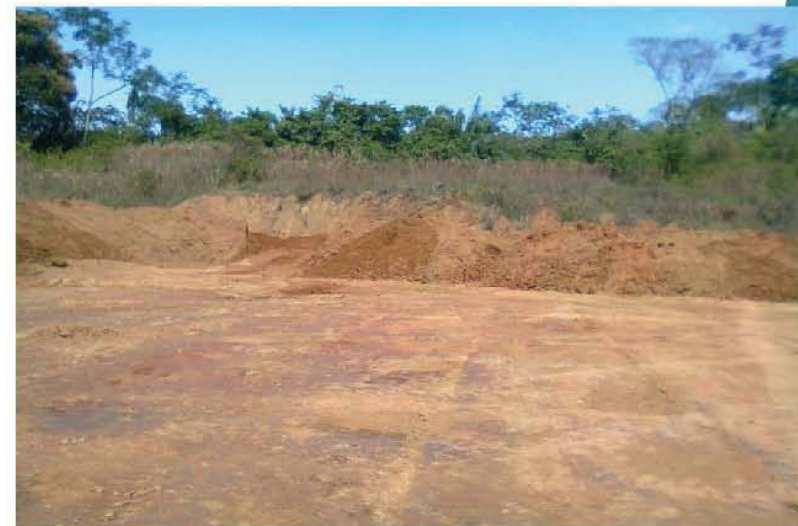
78 Imagen 34 y 35 corte del terreno para alcanzar el nivel de desplante seleccionado.
