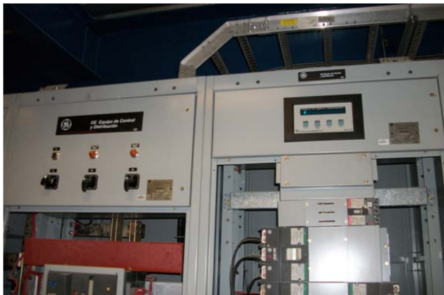
Fig. 3.5 El tablero de emergencia cuenta con medición digital, mientras el tablero de transferencia tiene un sistema de analógico de control.
