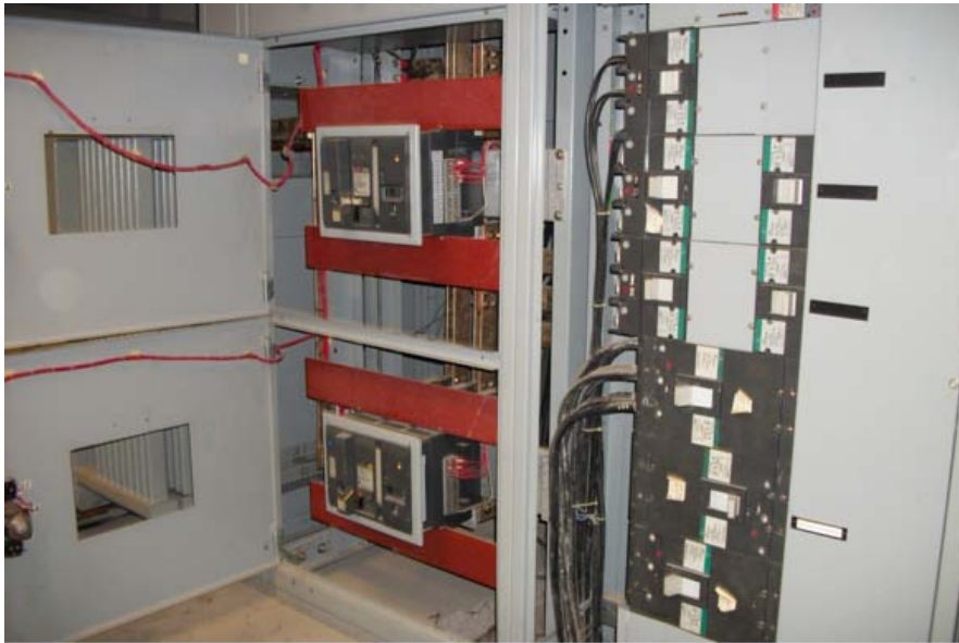
Fig. 3.4 Tablero de transferencia y tablero de emergencia.
