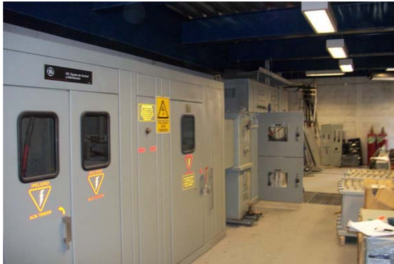
Fig. 3.1 Subestación eléctrica compacta de 750 KVA servicio interior
