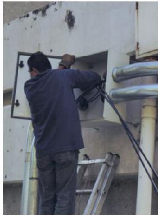
Figura 1.10 Acometida a Instalaciones STC
