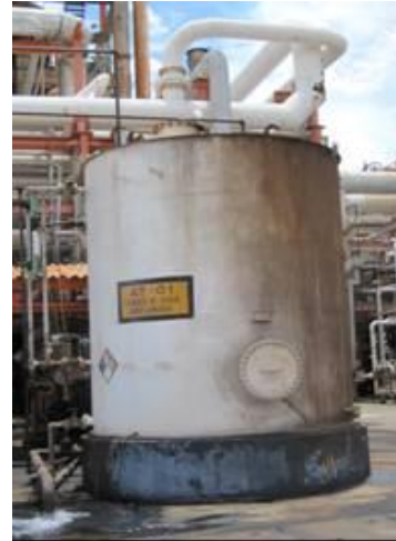
Figura 5. Tanque AT-01, acumulador de agua desflemada.
