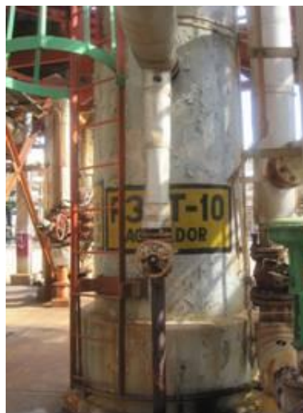
Figura 76. Torre agotadora de agua amarga F3-T-10.
