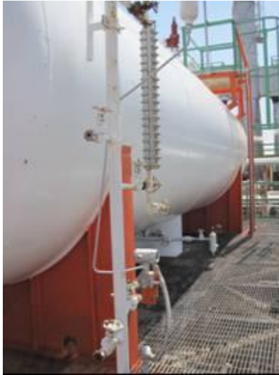
Figura 57. Tanque FA-3, acumulador de naftas de la fraccionadora DA-1
