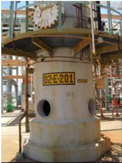
Figura 63. Torre lavadora 02-E-201
