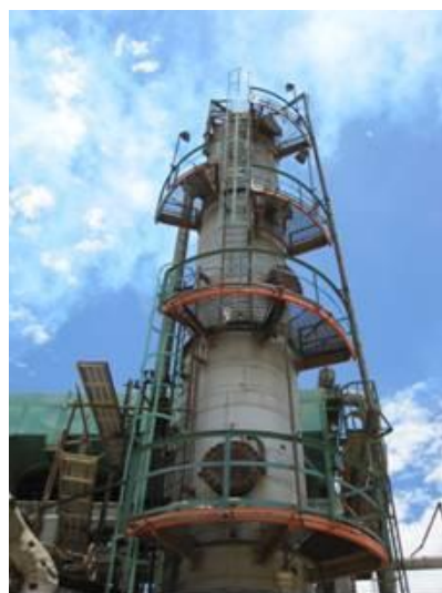
Figura 72. Torre agotadora de agua amarga ADA-81.
