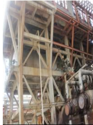
Figura 56. Tanque acumulador de la torre F3-T-1
