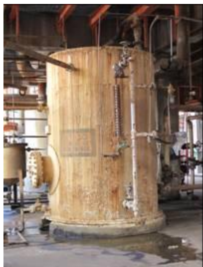
Figura 68. Tanque acumulador de agua amarga AT-10.
