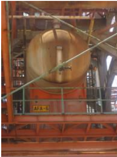
Figura 38. Tanque acumulador de la torre despuntadora AFA-6.
