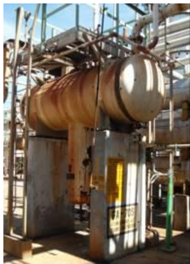
Figura 21. Tanque acumulador FA-705, de la torre agotadora.
