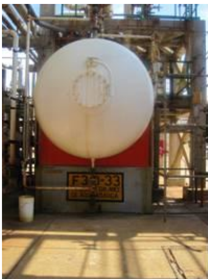
Figura 75. Tanque acumulador de agua amarga F3-D-33.
