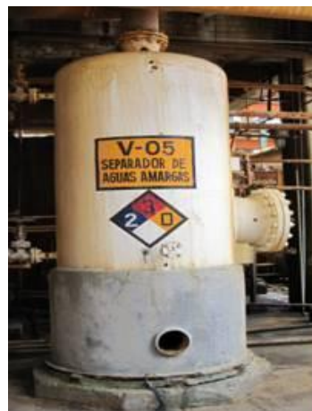
Figura 9. Tanque acumulador V-05. Separador de agua amarga.
