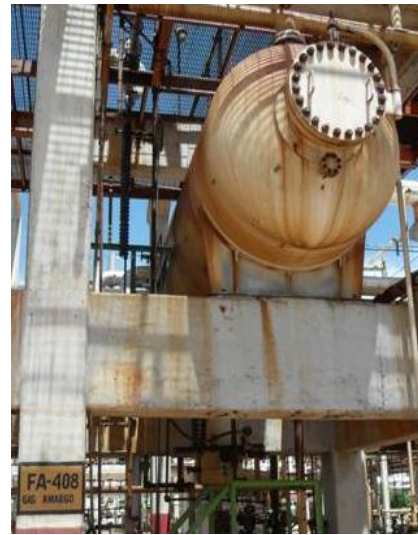
Figura 16. Tanque separador de agua amarga FA-408.
