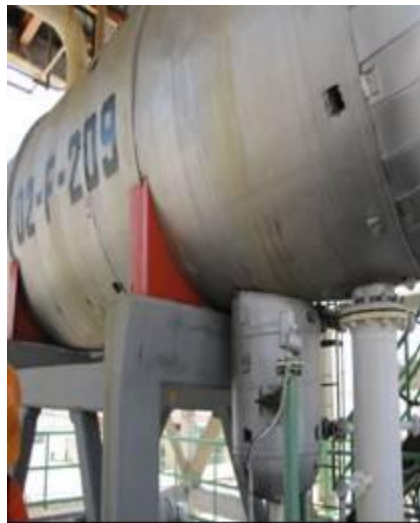
Figura 65. Tanque acumulador de la torre 02-E-201
