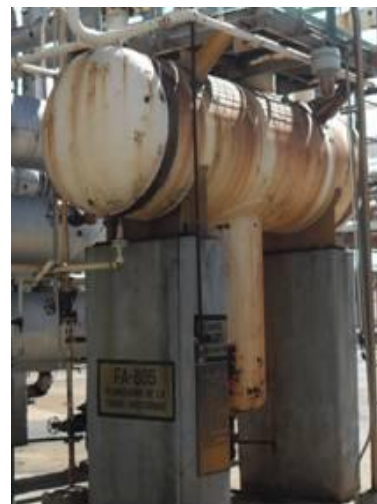
Figura 26. Tanque separador de agua amarga FA-805.
