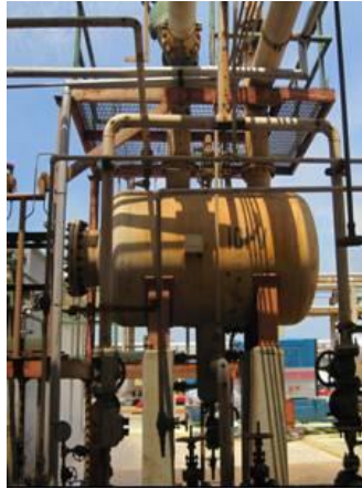
Figura 30. Tanque separador de agua amarga 101-V.
