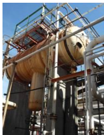
Figura 22. Tanque acumulador FA-706, de la torre fraccionadora.
