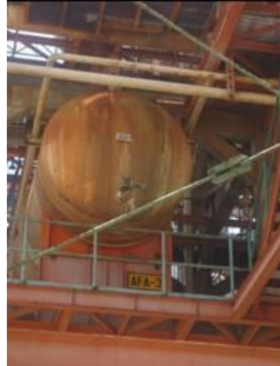
Figura 37. Tanque acumulador de la torre despuntadora AFA-3.
