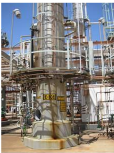
Figura 60. Torre lavadora de butano/butileno.
