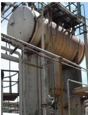
Figura 27. Tanque separador de agua amarga FA-806.
