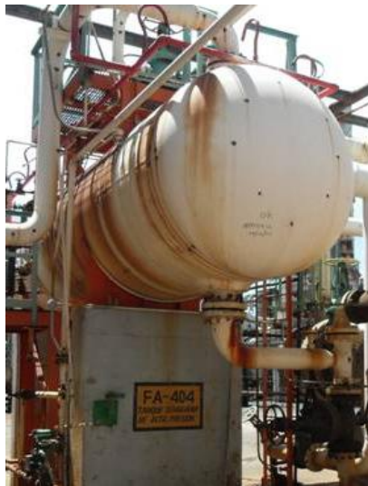
Figura 15. Tanque separador de agua amarga FA-404.
