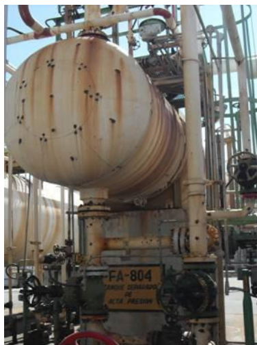
Figura 25. Tanque separador de alta presión FA-804.
