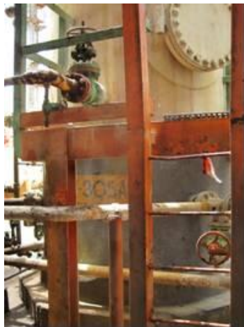
Figura 8. Acumulador V-305, Tanque acumulador de agua amarga.
