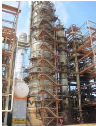
Figura 39. Tanque acumulador de la torre de destilación atmosférica.
