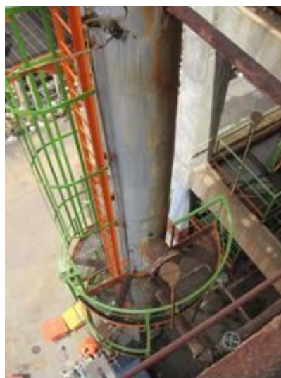
Figura 69. Torre agotadora de agua amarga T-03.
