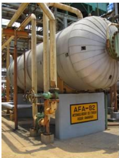
Figura 71. Tanque acumulador de agua amarga AFA-82.
