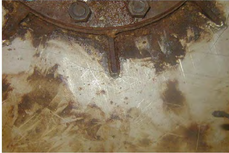
Figura 5. Corrosión generalizada en equipos de proceso.
