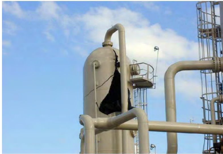
Figura 3. Daño en equipos de proceso.
