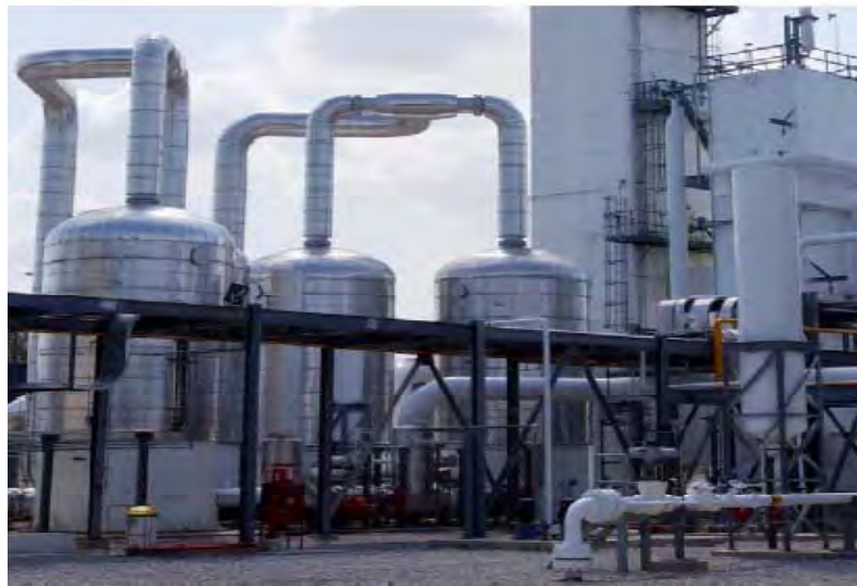
Figura 2. Instalaciones de proceso seguras.
