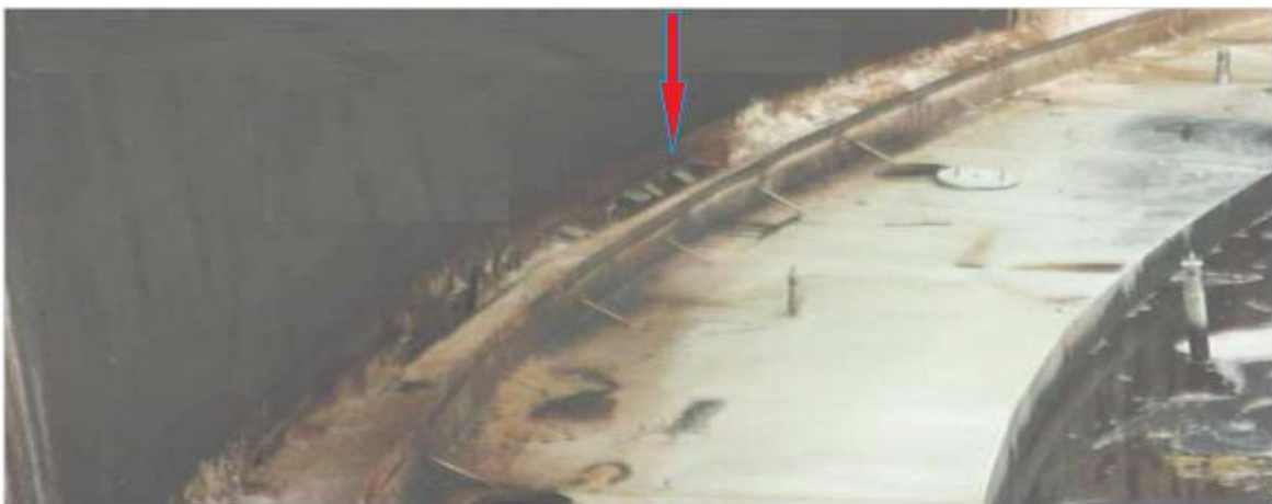
Figura 41. Incendio por Fallas en el Sello del Tanque.
