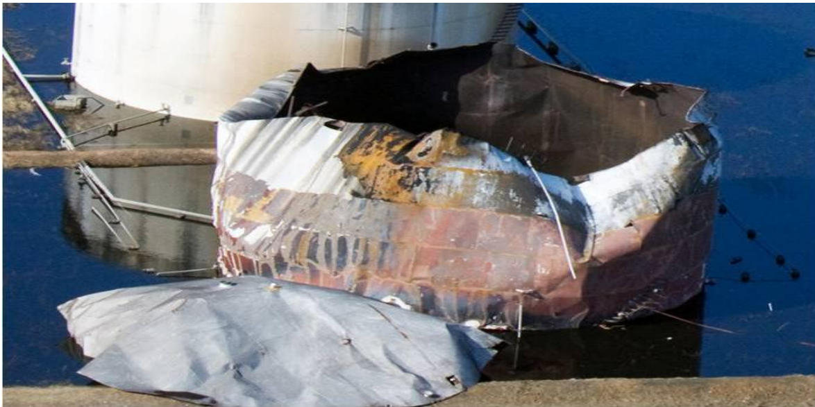
Figura 35. Desprendimiento Techo- Envolvente.
