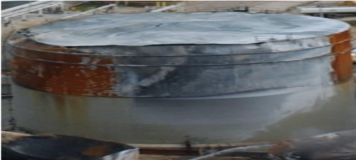
Figura 33. Colapso Anillo superior y Desprendimiento del Techo y la Envolvente.
