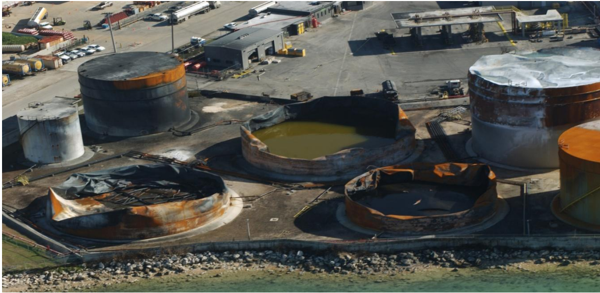
Figura 31. Colapso en Tanque Atmosférico de Almacenamiento.
