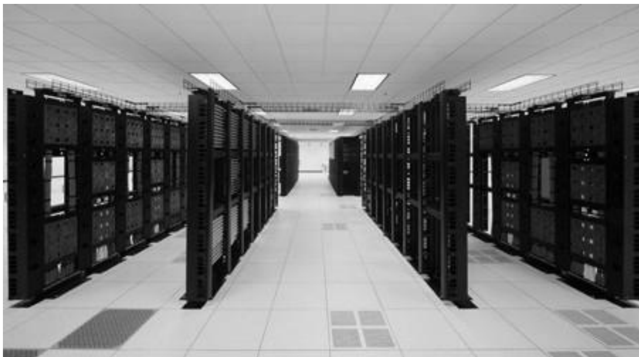
Figura 4.3 Distribución uniforme de los racks (voz y datos).
