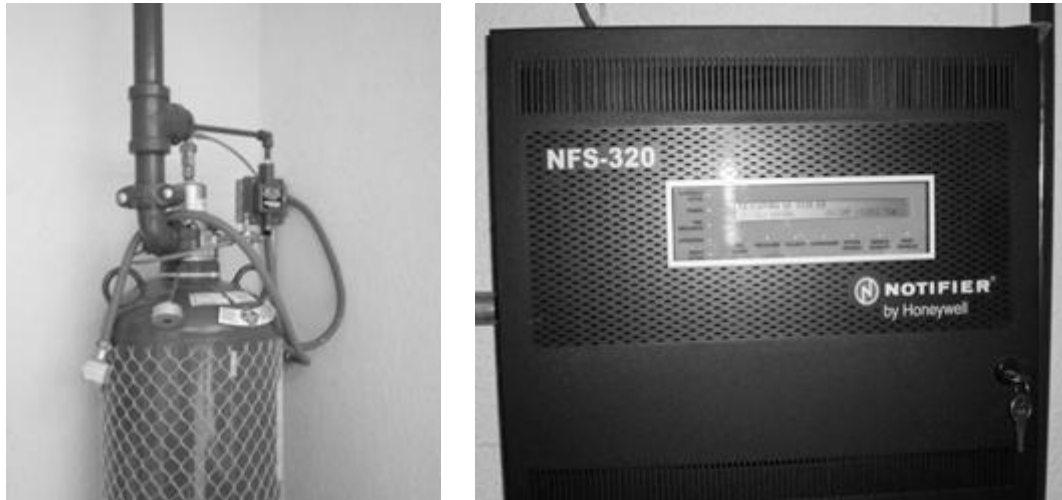
Figura 4.5. Sistema contra incendio FM-200.
