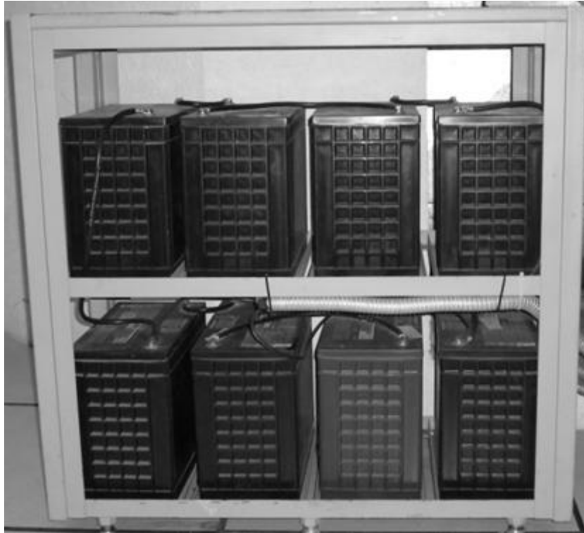
Figura 4.4. Banco de Baterías.
