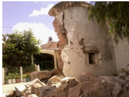
Imagen 5.40. Edificación en ruinas de la ex – hacienda Trinidad del Norte Autor: Karina Rivera Álvarez.
