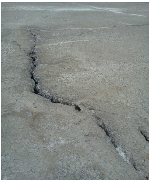
Figura 11. Agrietamiento del material aluvial.
