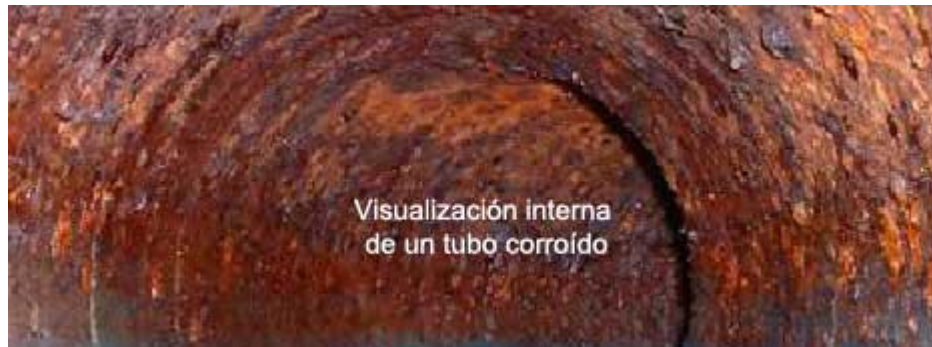
Figura 2.13 Visualización de tubería corroída.
