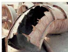
Figura 2.10 Pieza de tubería afectada por el desgaste
