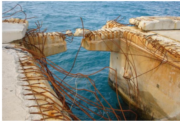
Fotografía No 36.- Desprendimiento de las losas recoladas.
