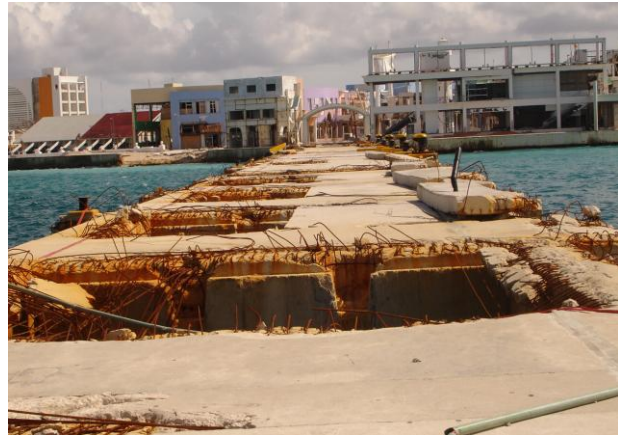
Fotografía No 35.- Colapso de losas precoladas.
