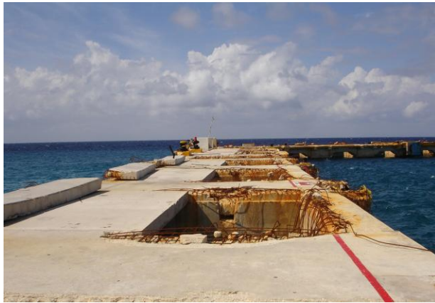
Fotografía No 30.- Losas totalmente destruidas.
