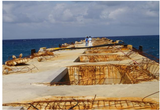
Fotografía No 31.- Sin losas ni traveses secundarios.
