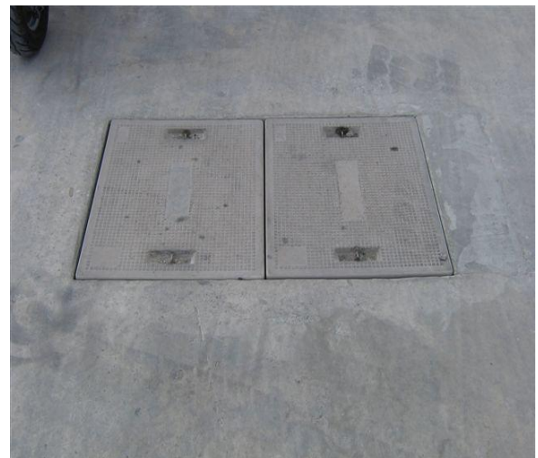
Fotografía No 48.- Registros de concreto
