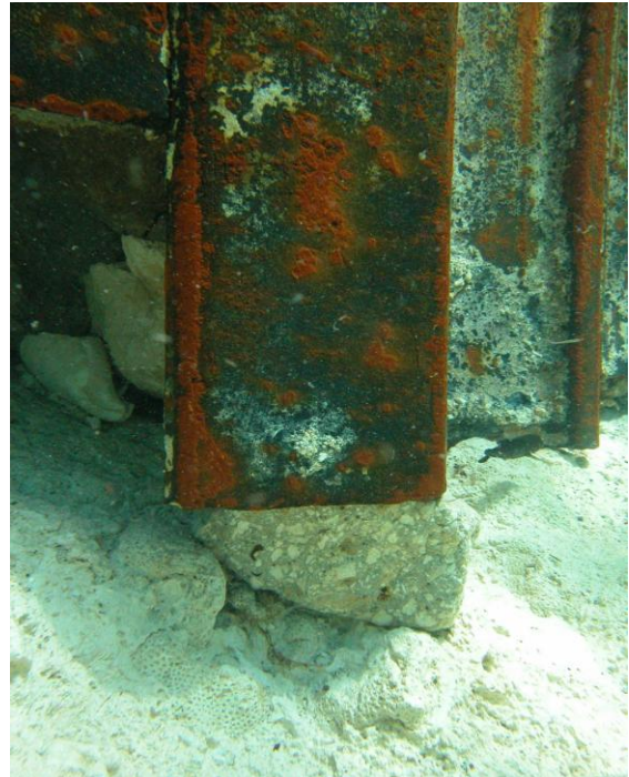
Fotografía No 25.- Erosión de la arena en el fondo marino causado por el paso del huracán.
