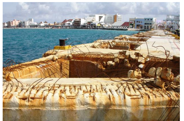
Fotografía No 33.- Losas totalmente colapsadas.
