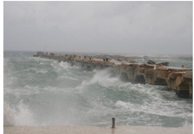
Fotografía No 23.- Se aprecia ya el desprendimiento de las losas, esto en la pasarela de acceso.
