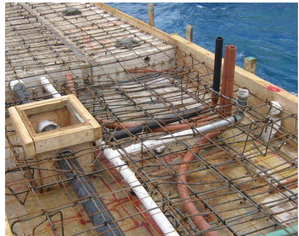
Fotografía No 44.- Salidas de instalaciones.
