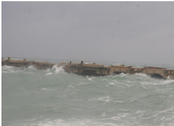
Fotografía No 22.- Se muestra el oleaje ciclónico chocando sobre la estructura del muelle.
