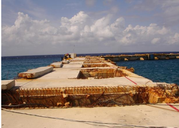
Fotografía No 34.- Losas precoladas en la unión de módulos colapsadas.
