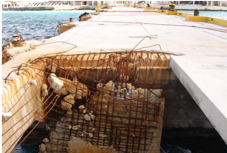
Fotografía No 24.- Losas totalmente colapsadas.
