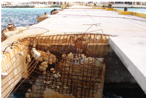
Fotografía No 32.- Bloque de losa totalmente colapsado.
