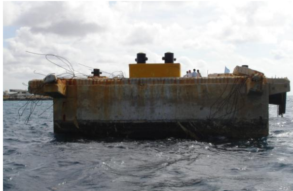
Fotografía No 38.- Losa final totalmente colapsada.
